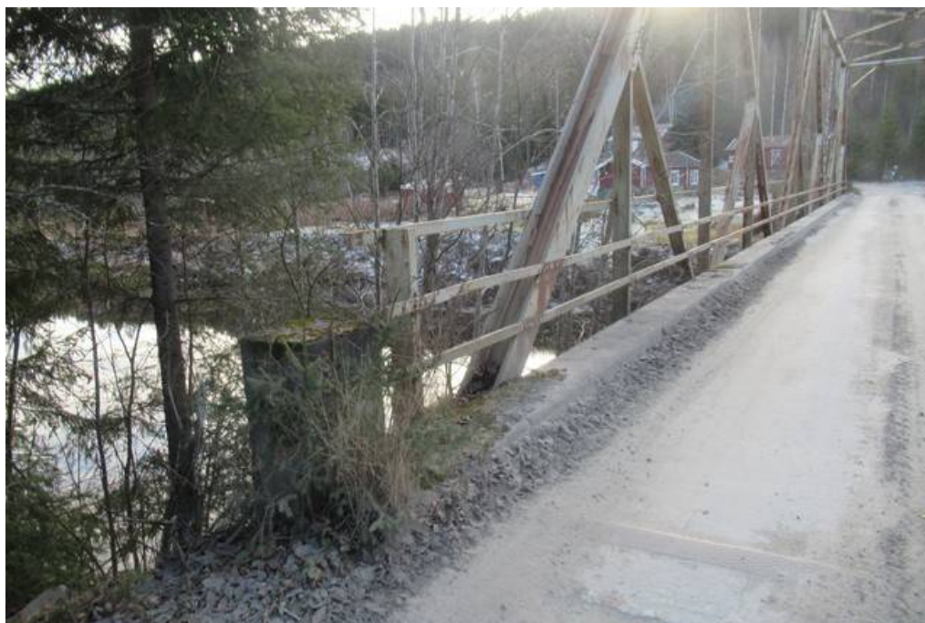
Bilde 28: Betongstabbe, rekkverk
