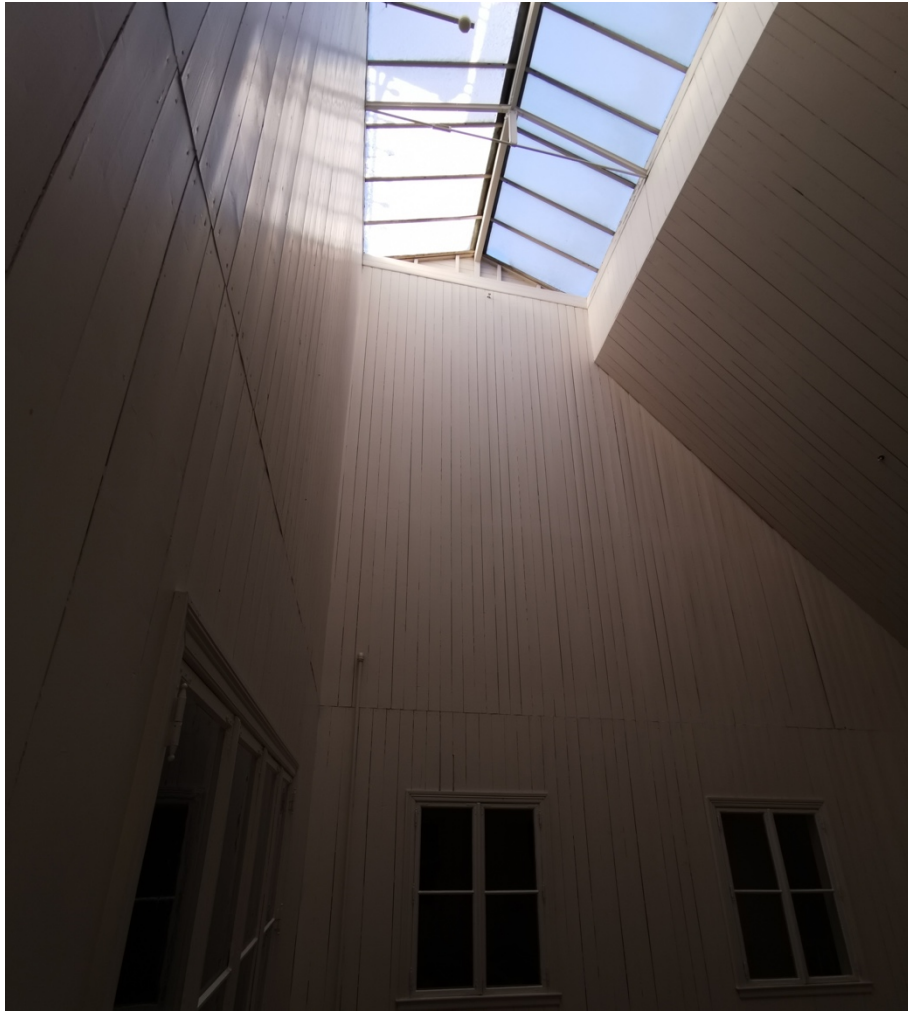
Glasstak sett nedenfra - antatt opprinnelig stålkonstruksjon i midten inkludert sperrebind - foto Arkitektskap
