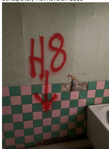
Bilde 13. Prøvetatte keramiske veggfliser, baderom, Holmsveien 2057 (prøve H8). Flisene inneholder asbest
