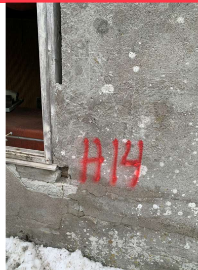
Bilde 43. Prøve av betong fra smie (prøve H14). Betongen er forurenset med sink over normverdi
