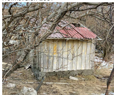
Bilde 10. Bølgeeternitt på tak på uthus/skur, Holmsveien 2059
