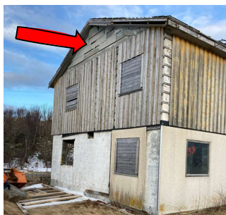
Bilde 9. Tak- og veggplater med asbest, Holmsveien 2059
