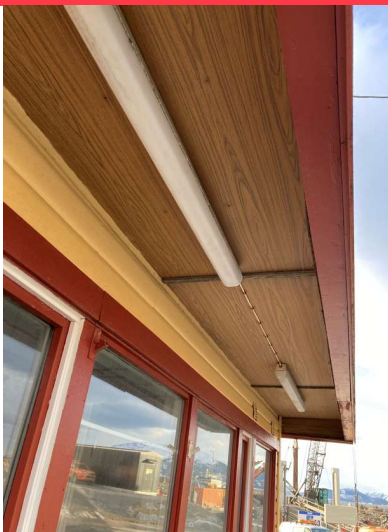
Bilde 16. Lysstoffrør tilknyttet kiosk
