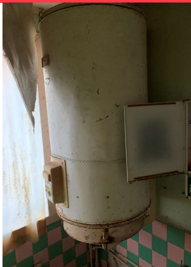
Bilde 15. Varmtvannsbereider, baderom, Holmsveien 2057
