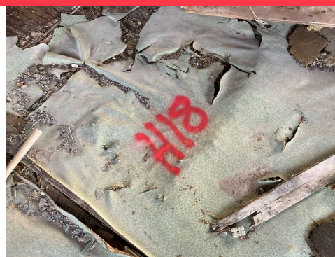
Bilde 24. Prøvetatt gulvbelegg i Holmsveien 2059. Gulvbelegget håndteres som farlig avfall med ftalater.
