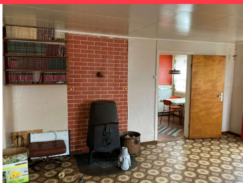
Bilde 22. Vinylbelegg på gulv i stue, Holmsveien 2057 (prøve H1) må håndteres som farlig avfall med klorparafiner
