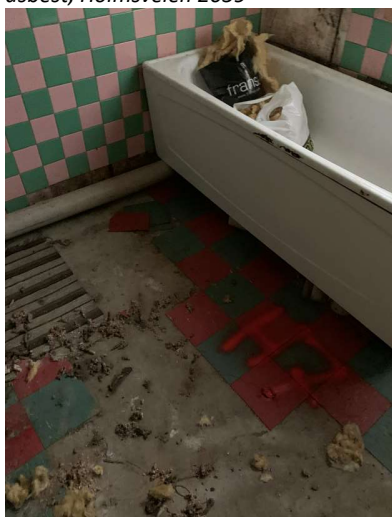
Bilde 12. Prøvetatte vinylfliser på gulv, baderom, Holmsveien 2057 (prøve H7). Vinylflisene inneholder asbest
