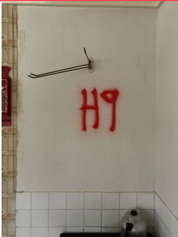
Bilde 39. Hvit maling på pipeløp i kjøkken, Holmsveien 2057 (prøve H9) må håndteres som lettere forurenset med bly, sink og PCB
