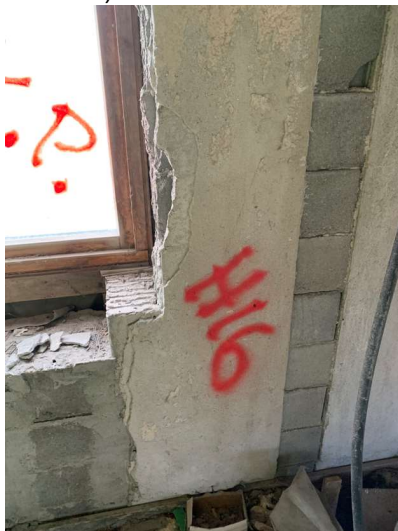
Bilde 44. Prøvetatt murpuss (prøve H16) og betong (prøve H17) fra Holmsveien 2059. Murpussen er forurenset med kobber over normverdi. Betongen er ren.
