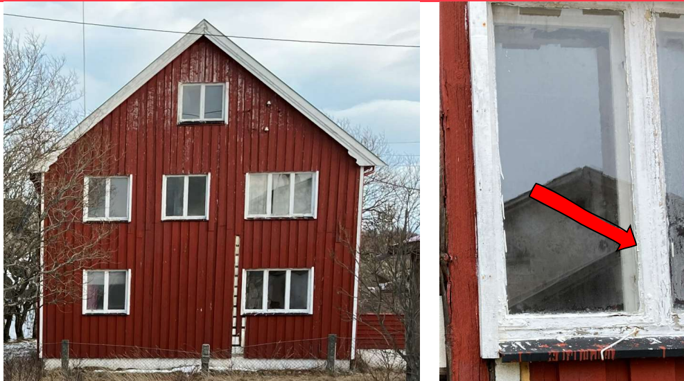
Bilde 21. Fuger på enkeltglasstuter tilkn. Holmsveien 2057 må håndteres som farlig avfall med ftalater.
