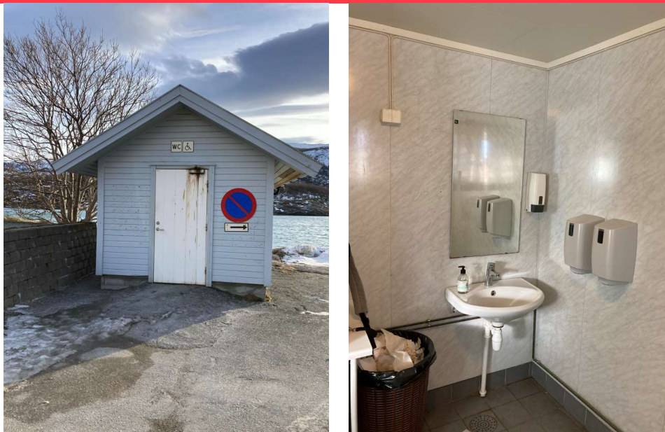
Bilde 53. Baderomsplater i WC-bygg må håndteres som farlig avfall med pentaklorfenol
