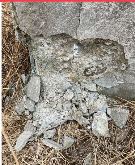
Bilde 42. Prøve av murpuss i Holmsveien 2057 (prøve H13) Murpussen er forurenset med sink over normverdi
