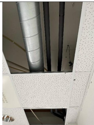
Rørisolasjon med cellegumme (brommerte flammehemmere) over systemhimling.
