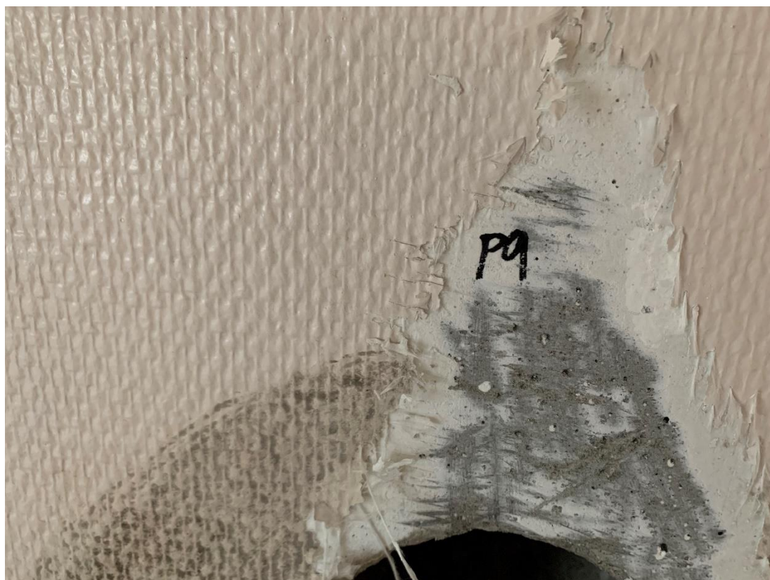
Bilde 8 – Bilde fra prøve 9. Hvit maling på betongvegg ble analysert for tungmetaller og klorparafiner. Prøven viser ingen forekomst av klorparafiner, og en forekomst av tungmetaller under grenseverdi for farlig avfall.
