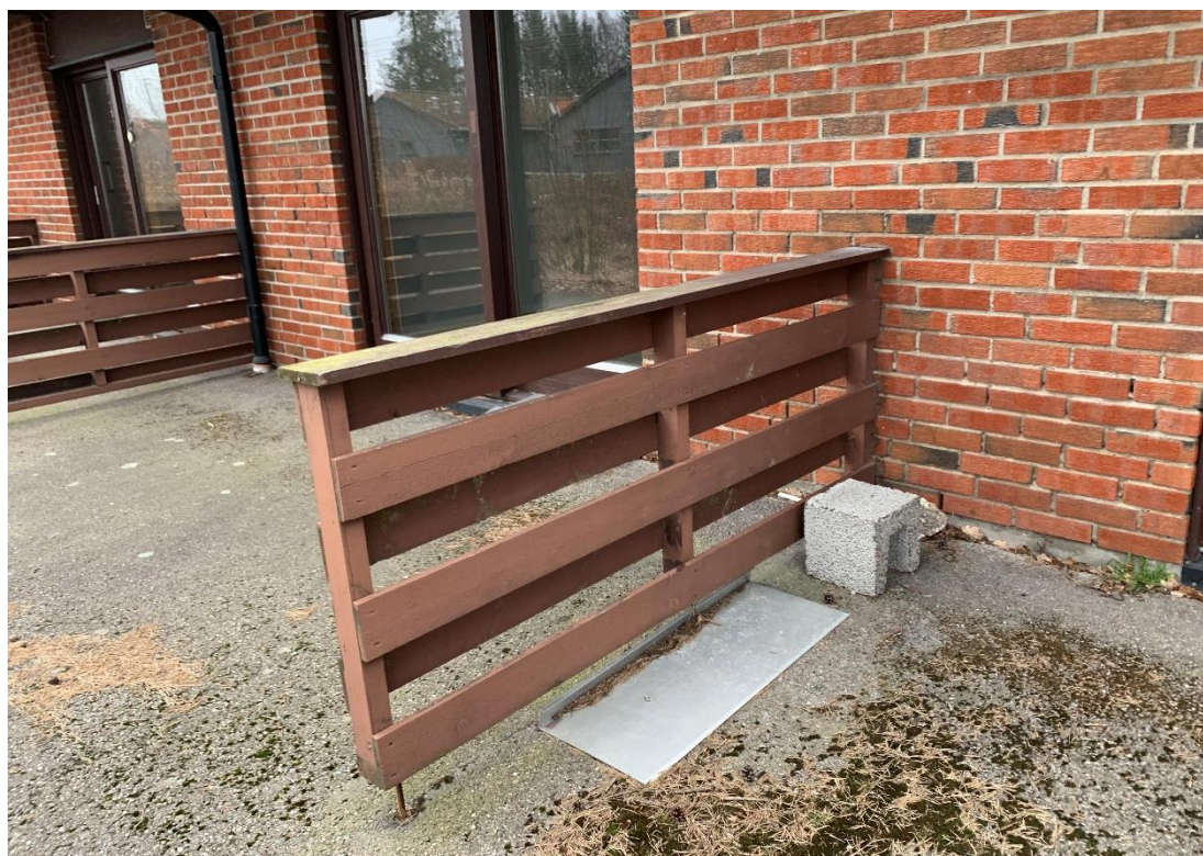
Bilde 12 – Bildet viser skillerekkverk mellom leilighetene, som antas å være av CCA-impregnert tre. CCA-impregnert tre må leveres som farlig avfall til godkjent mottak. Mengder i tabell, punkt 4.4.
