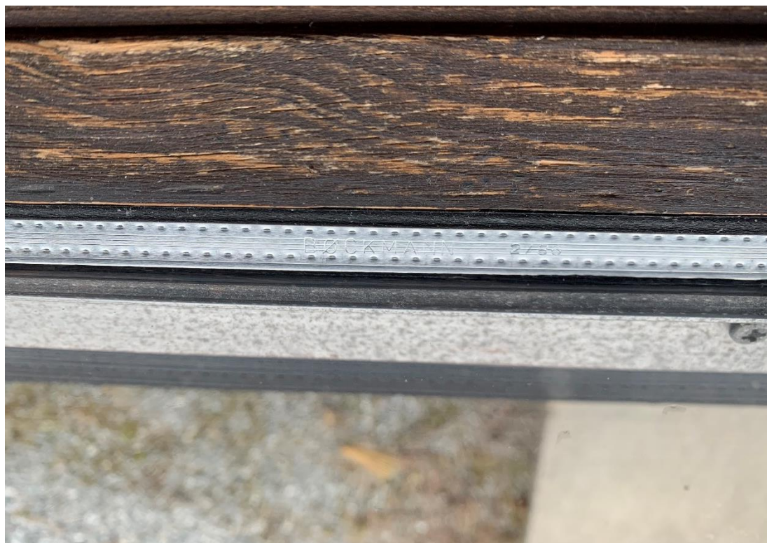
Bilde 11 – Bildet viser merking av isolerglassrute i bygget. Basert på produksjonsår (1986) antas det at disse vinduene inneholder klorparafiner og må derfor leveres som farlig avfall til godkjent mottak. De fleste isolerglassrutene var produsert i dette årstallet, men noen av vinduene i bygget er produsert etter 1990 og kan håndteres som ordinært avfall. Mengder i tabell, punkt 4.4.
