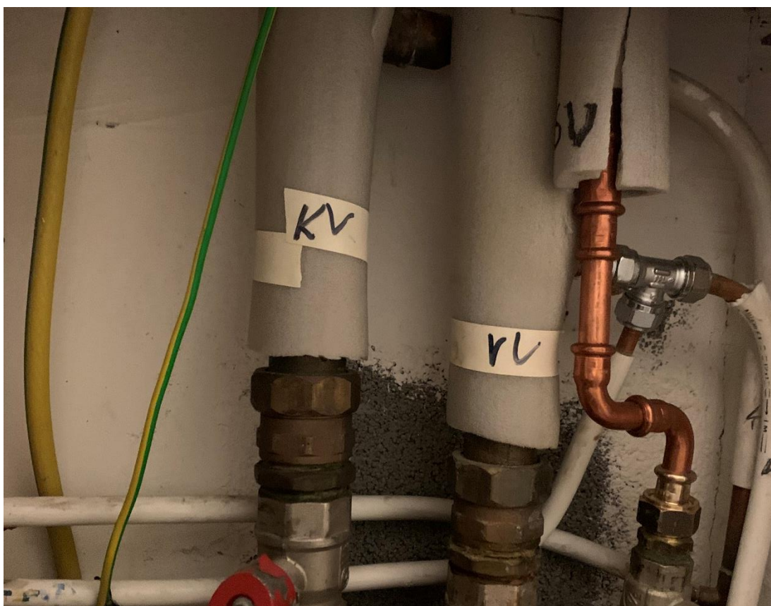
Bilde 14 – Bildet viser rørisolasjon av cellegummi inni en sjakt i et av beboerbadene. Cellegummi inneholder erfaringsmessig bromerte flammehemmere, og må leveres som farlig avfall til godkjent mottak. Mengder i tabell, punkt 4.4.
