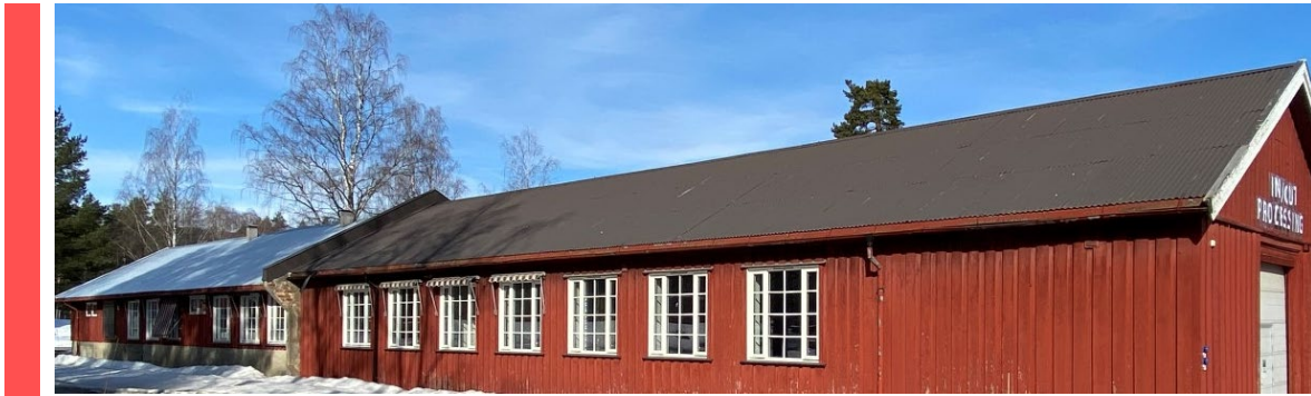
Figur 17 Taket på bygg 56 har stålplater med underliggende takpapp som må antas å være farlig avfall.
