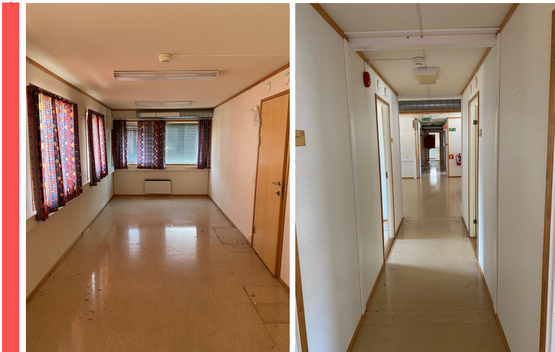
Figur 10 Alle rom i bygg 34 har samme vinylbelegg. Skal håndteres som farlig avfall med ftalater.
