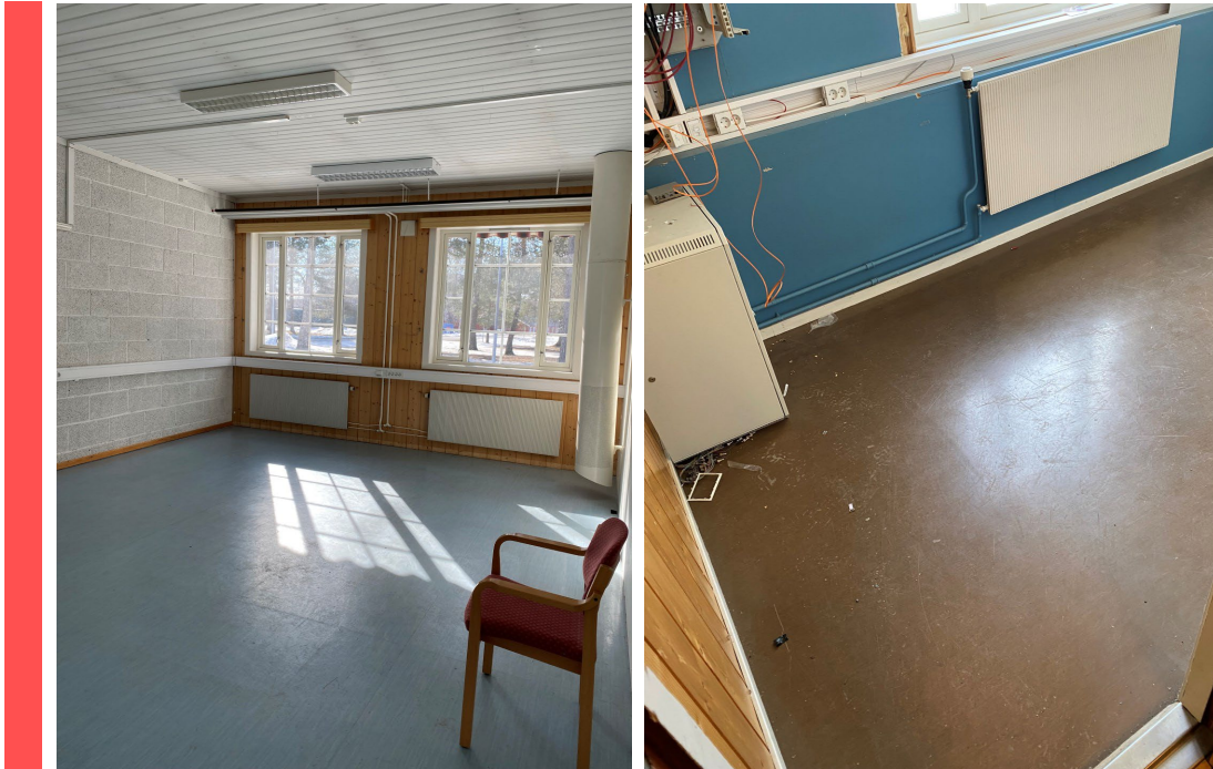
Figur 11 Eksempler på rom i bygg 56 med vinylbelegg. Skal håndteres som farlig avfall med ftalater.
