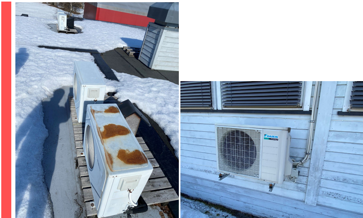
Figur 20 Registrerte kjølemaskiner i bygg 34 (5 stk.). Inneholder hhv. R22 og R410A kuldemedium.
