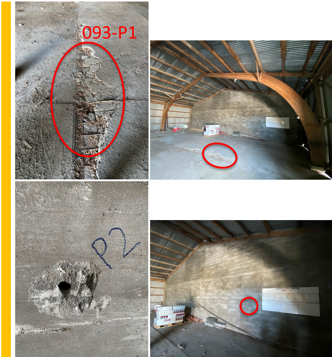
Figur 21 Betongplate på mark og skillevegger mellom seksjonene i bygg 93 er ordinært avfall.
