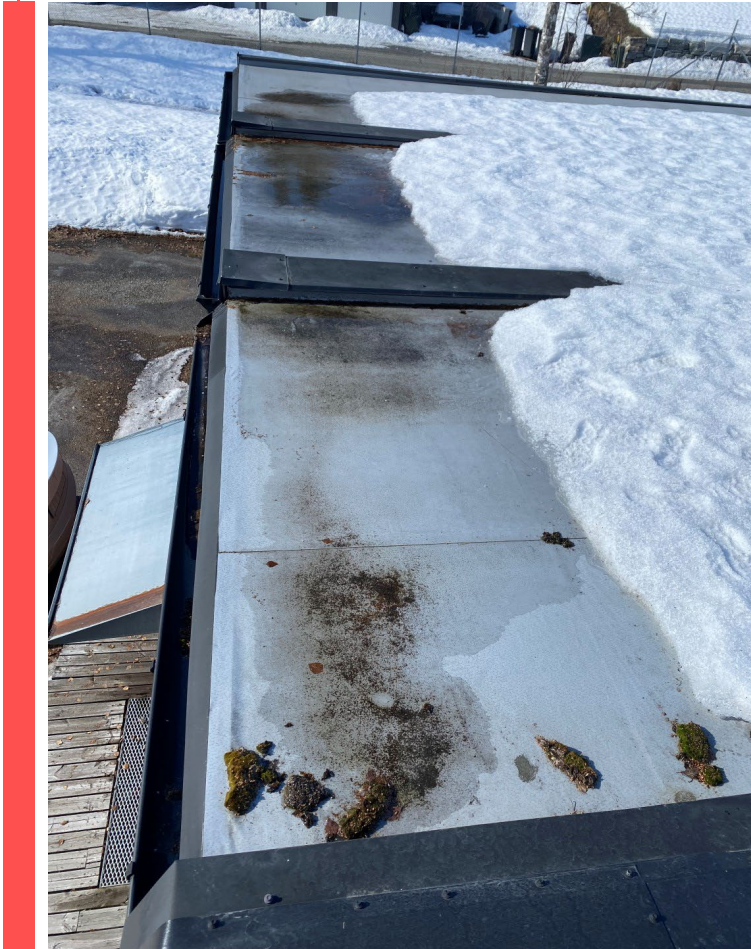
Figur 15 PVC-takmembran på 6 av brakkene (bygg 34) inneholder ftalater som trolig gjør belegget til farlig avfall.
