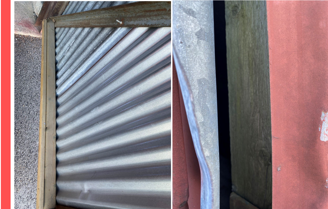
Figur 19 Lekter på garasjeportene skal sorteres ut som CCA-impregnert trevirke (farlig avfall).
