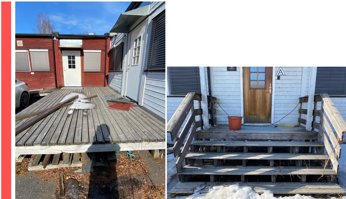
Figur 18 Rampe, plattning og trapp til bygg 34 skal sorteres ut som CCA-impregnert trevirke (farlig avfall).
