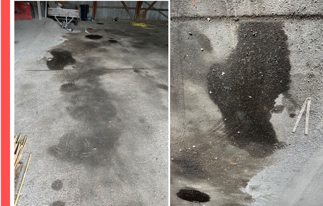
Figur 23 Synlig oljeforurensset betong i bygg 93. Skal sorteres ut og leveres som farlig avfall med innhold av olje.
