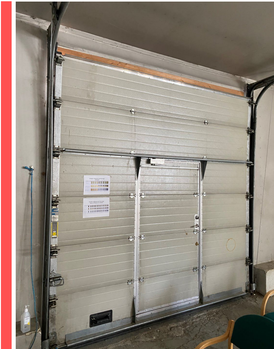
Figur 14 Leddport i bygg 56 som må antas å være isolert med PUR-skum. Skal håndteres som farlig avfall.
