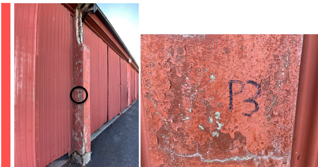
Figur 22 Maling på skillevegger utenfor fasadelivet i bygg 93 er farlig avfall med innhold av sink.
