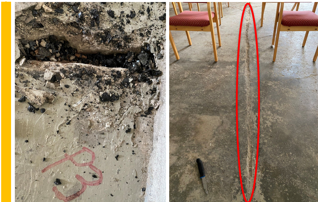
Figur 12 Svart dilatasjonsfuge i betongdekke i garasjen i bygg 56 kan håndteres som ordinært avfall.
