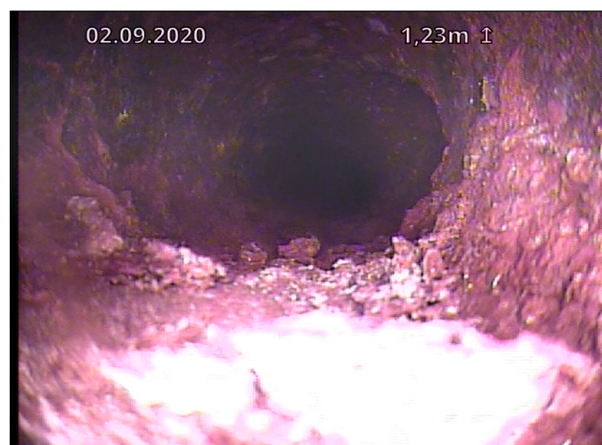
Foto: S_Sectionname_75 mm stiger_Hovedstrekk_20200911_1344_A.jpg 1,2m, Sedimentering,dybde på avsetning er mellom 15-30%, fra 04 til 08 Kl., Andre, Løs rust, Start
