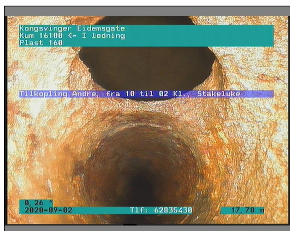
Foto: 4_1_7_02092020_101751_A.JPG 17,78m, Tilkopling Andre, fra 10 til 02 Kl., Stakeluke
