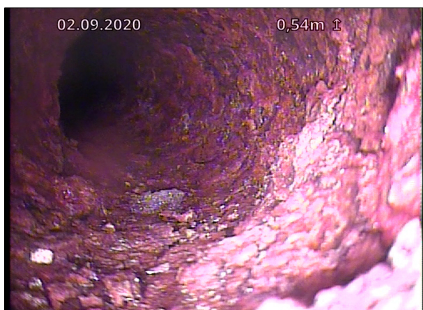
Foto: S_Sectionname_75 mm stiger_Hovedstrekk_20200911_1343_B.jpg 0,1m, Utfelling/Belegg, reduksjon i tverrsnittsarealet er mellom 15 - 30%, fra 12 til 12 Kl., Andre, Rustbelegg, Start
