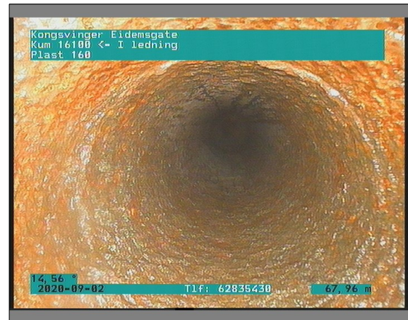
Foto: 4_1_28_02092020_104743_B.JPG 67,79m, Retningsending 12 Kl., Prefabrikkert bend, Opp i kulvert
