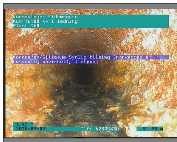
Foto: 4_1_19_02092020_103703_A.JPG 51,98m, Korrosjon/Slitasje Synlig tilslag (rørveggen er betydelig påvirket), I støpejernsrør er det begynnende rustangrep, fra 12 til 12 Kl.
