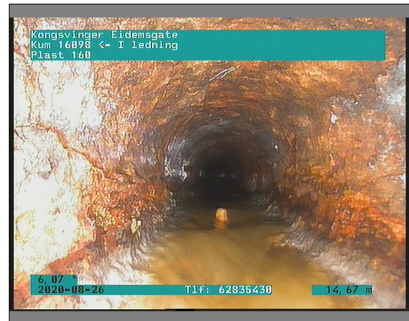
Foto: 1_1_9_26082020_093139_A.JPG 14,67m, Utfelling/Belegg, reduksjon i tverrsnittsarealet er mellom 15 - 30%, fra 12 til 12 Kl., Andre, Rust, Start
