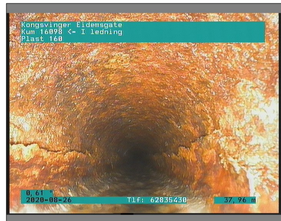
Foto: 1_1_14_26082020_095327_A.JPG 29,29m, Utfelling/Belegg, reduksjon i tverrsnittsarealet er mellom 15 - 30%, fra 03 til 09 Kl., Andre, Rustbelegg
