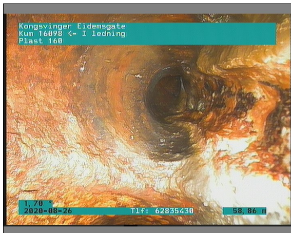
Foto: 1_1_35_26082020_101743_A.JPG 58,85m, Vann fra stikkledning 5%
