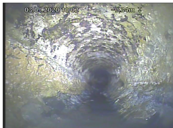
Foto: S_Sectionname_Stiger trappegang_Gren hovedstrekk_20200911_1408_A.jpg 0,1m, Korrosjon/Slitasje, Manglende tilslag (rørveggen er sterkt påvirket), I støpejernsrør er det kraftig rustangrep, fra 12 til 12 Kl., Start
