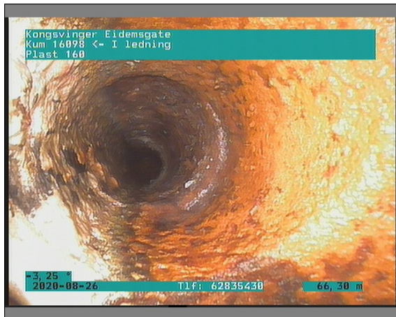
Foto: 1_1_43_26082020_102639_A.JPG 66,3m, Vann fra stikkledning 5%
