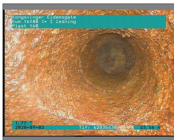
Foto: 4_1_8_02092020_102149_A.JPG 23,56m, Plugget tilkopling fra 01 til 04 Kl., Plugget ?
