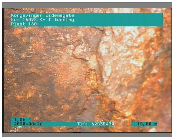
Foto: 1_1_9_26082020_093208_B.JPG 14,67m, Utfelling/Belegg, reduksjon i tverrsnittsarealet er mellom 15 - 30%, fra 12 til 12 Kl., Andre, Rust, Start
