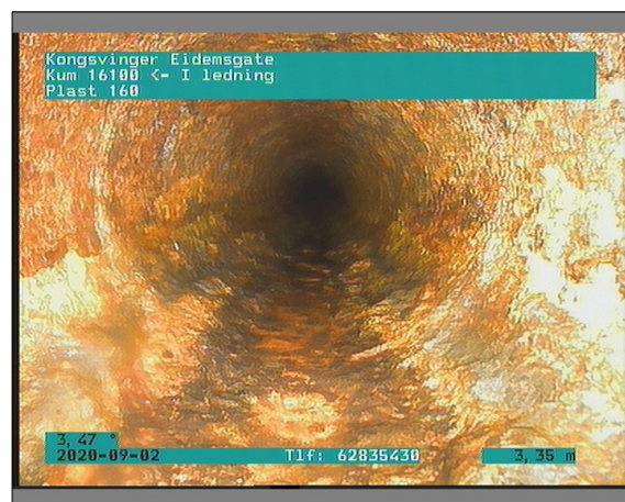
Foto: 4_1_3_02092020_101024_B.JPG 3,25m, Utfelling/Belegg, reduksjon i tverrsnittsarealet er mellom 15 - 30%, fra 12 til 12 Kl., Andre, Rustbelegg, Start
