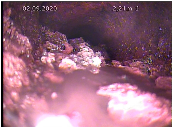
Foto: S_Sectionname_75 mm stiger_Hovedstrekk_20200911_1345_B.jpg 1,2m, Sedimentering,dybde på avsetning er mellom 15-30%, fra 04 til 08 Kl., Andre, Løs rust, Start
