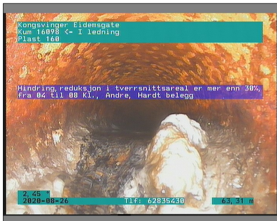
Foto: 1_1_41_26082020_102311_A.JPG 63,31m, Hindring, reduksjon i tverrsnittsareal er mer enn 30%, fra 04 til 08 Kl., Andre, Hardt belegg
