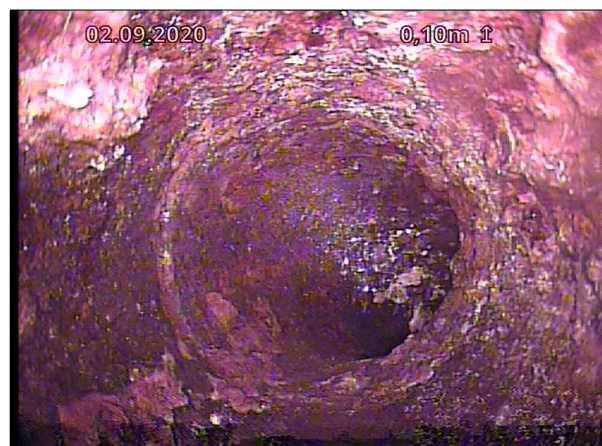
Foto: S_Sectionname_75 mm stiger_Hovedstrekk_20200911_1342_A.jpg 0,1m, Utfelling/Belegg, reduksjon i tverrsnittsarealet er mellom 15 - 30%, fra 12 til 12 Kl., Andre, Rustbelegg, Start
