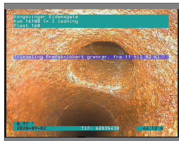
Foto: 4_1_16_02092020_103211_A.JPG 44,12m, Tilkopling Prefabrikkert grenrør. fra 11 til 02 Kl., I bruk ?
