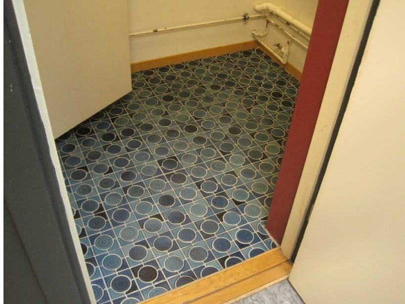
Bilde 8. Fliser og fuger i rom med vask i 3. etasje, fra antatt 70-tallet. Kan ha innhold av asbest og er ikke tatt prøve av ved befaring da rommet var i bruk.
