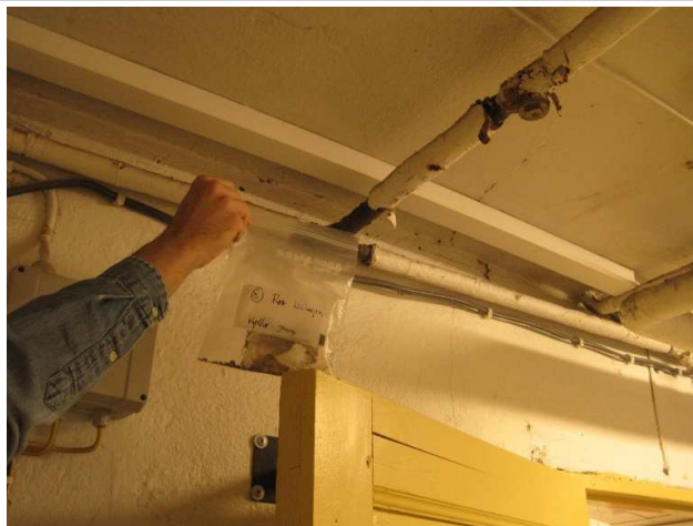
Prøve 8: Allerede løsnet isolasjon fra rør i kjeller (tar vanligvis ikke asbest prøver så lenge bygg/rom er i bruk).
