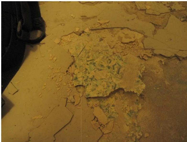
Bilde 4. Lag med maling/epoxybelegg i trapperom og oppover i trapper.
