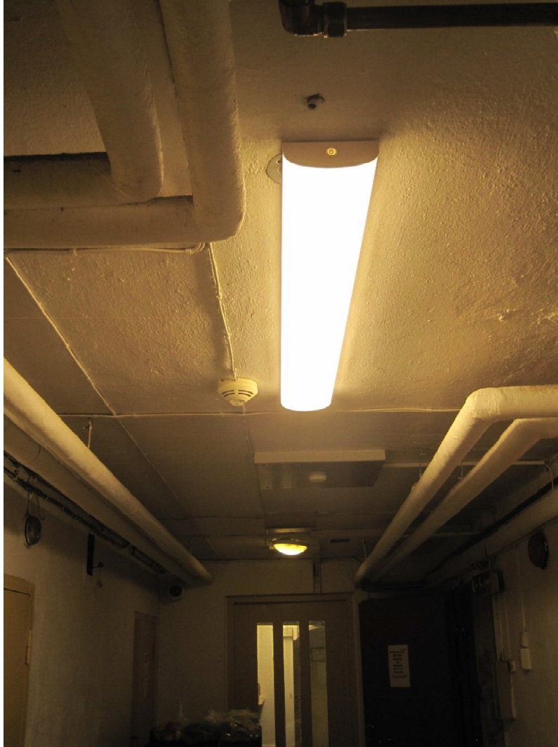
Bilde 11 Eksempel på EE-avfall i kjeller med lysarmatur, brannvarsler, ledninger og kabelgater
