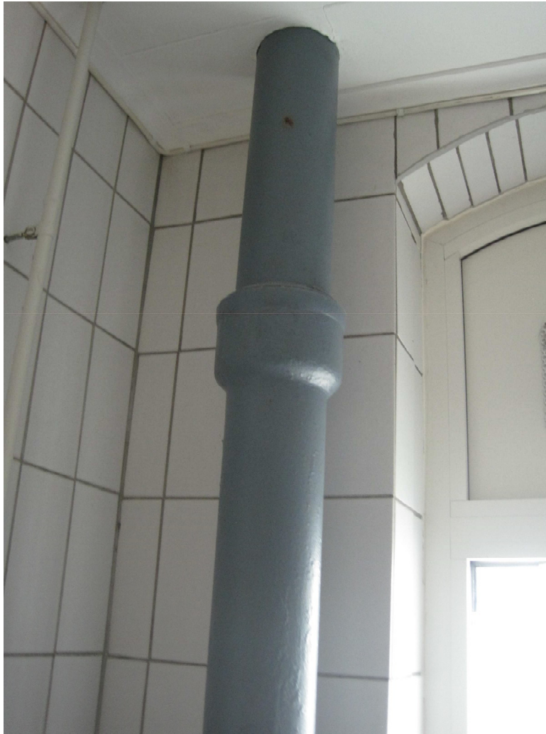
Bilde 15 Støpejernsrør hvor skjøter kan inneholde bly og pakninger kan ha innhold av asbest.
