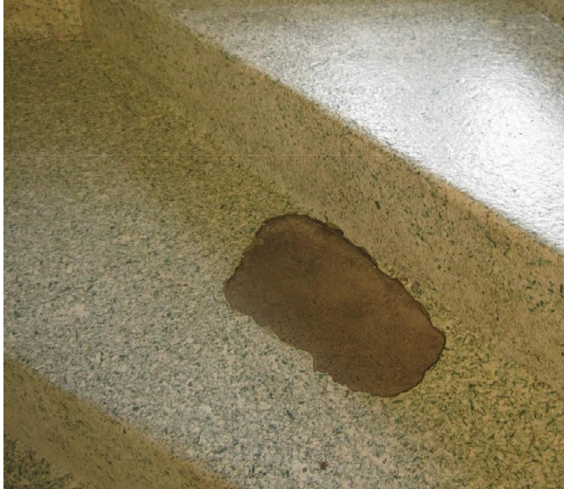
Bilde 5 Samme lag som prøve 2, oppover i trappen. Her løsnet laget enkelt fra betongen i trappen.
