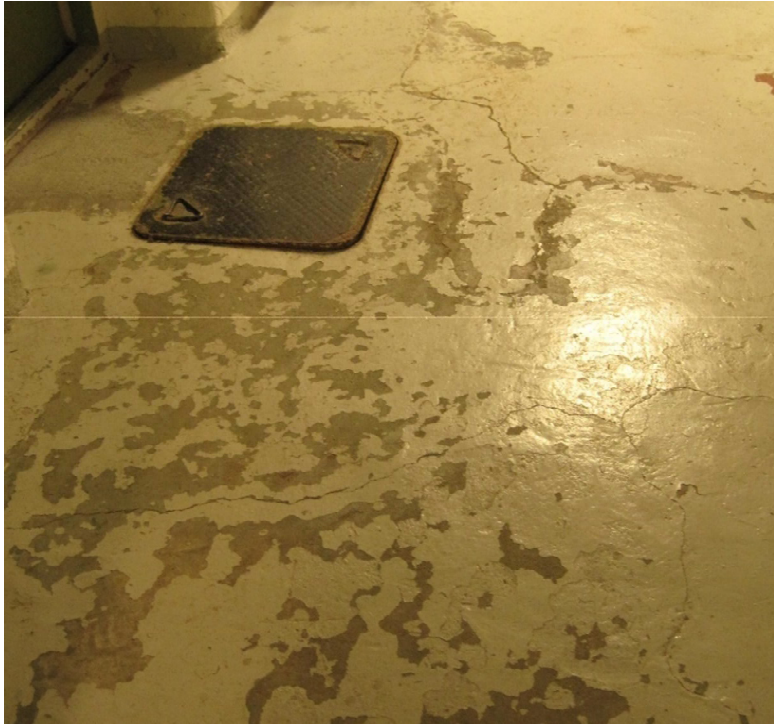
Bilde 3 Malingslag på gulv i kjeller, i gangen.
