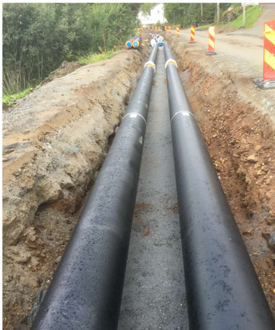
To singel fjernvarmerør i stål og plastkappe.
