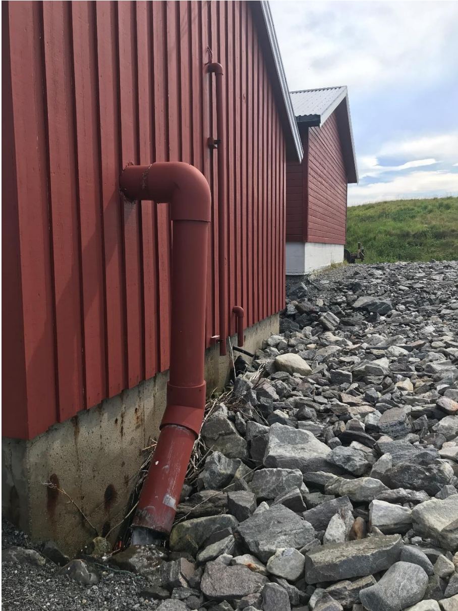
Figur 16: Overløp råvannstank, utløp konsentrat og tømning sandfilter
