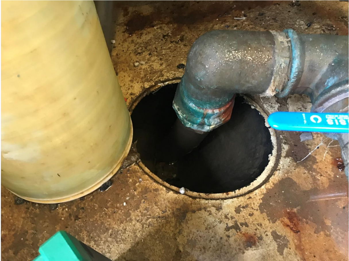
Figur 9: Utløp vannverk - i gulv
