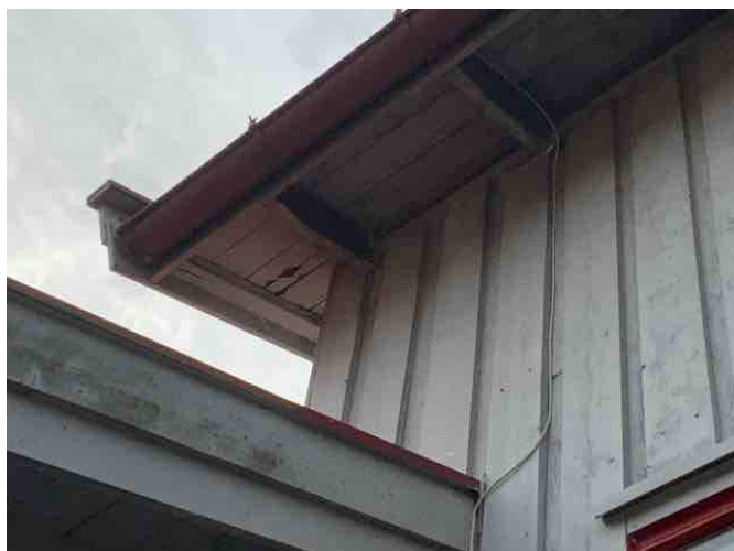
Bildet viser råteskader i utvendig gesims på grendehuset fra 1994.
