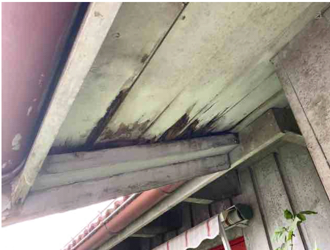
Mye råteskader er registrert i undertaket på hovedbygget. Observasjonene er gjort tre steder på utsiden. Dette er en indikasjon på svekkelser i taktekkingen og det må påregnes mer svekkelser når takstein fjernes.
