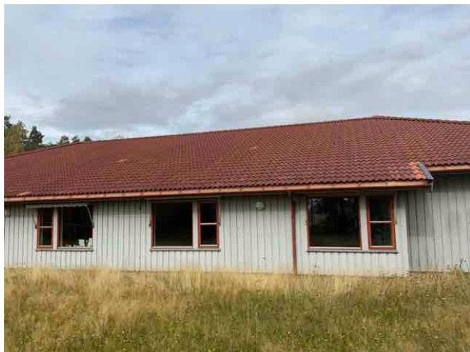
Taktekkingen på bygg fra 1997 ser en del bedre ut en hovedbygget fra 1988. Ingen indikasjoner på lekkasjer.
