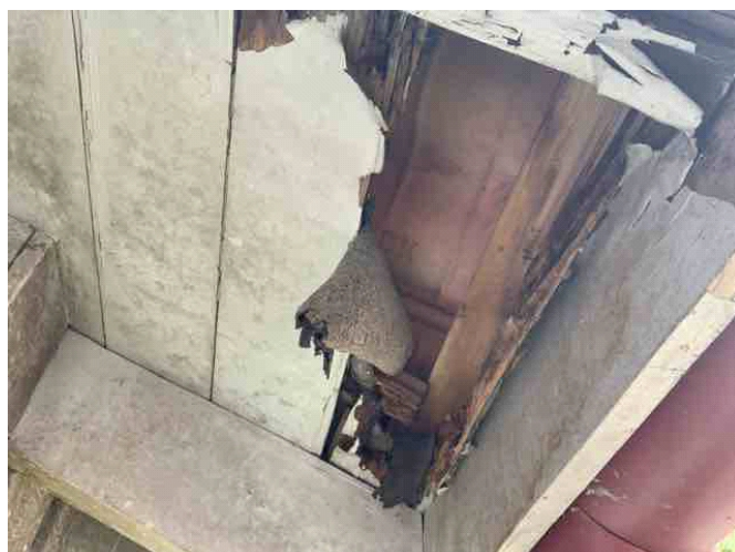
Bilder viser tegn til lekkasjer og råteskader i undertaket på hovedbygget.
