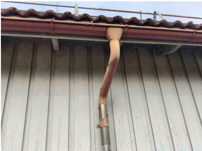
Flass, rust og dårlige skjøter tilhørende hoveddel fra 1988.
