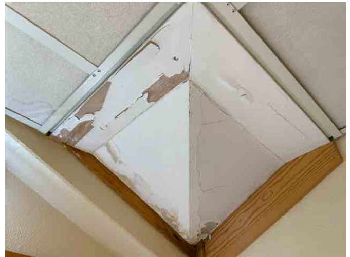
Noe fuktskader som har trukket inn i hovedbygget. Dette har sammenheng med utvendige svekkelser og mer skader en det som er synlig må påregnes.
