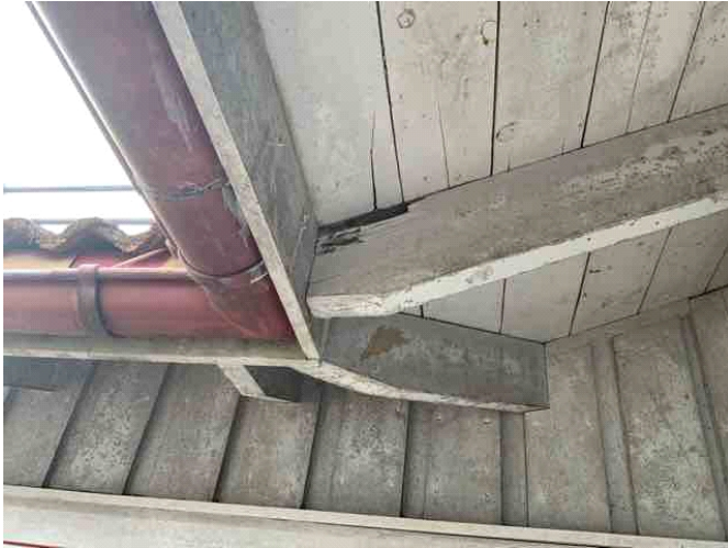
Flere råteskader bjelke tilhørende hoveddel fra 1988.
