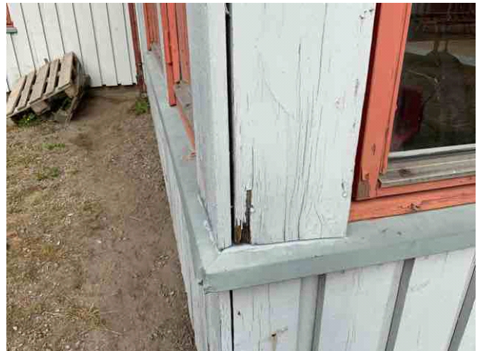
Stedvise råteskader på hovedbygget fra 1988.
