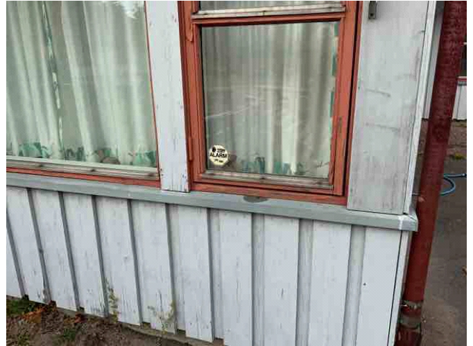
Generelt slitte vinduer på hovedbygget fra 1988.
