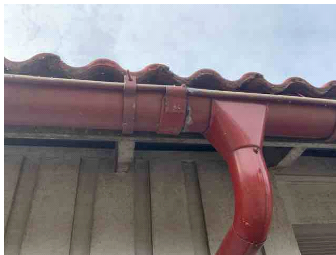
Bildet viser dårlige skjøter på renner og nedløp på grendehuset fra 1994.
