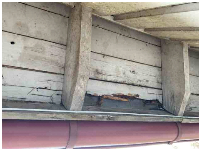
Bildet viser råteskader i utvendig gesims og taksperrer på grendehuset fra 1994. Dette gir en indikasjon på utettheter og mer skader er påregnelig når takstein fjernes.
