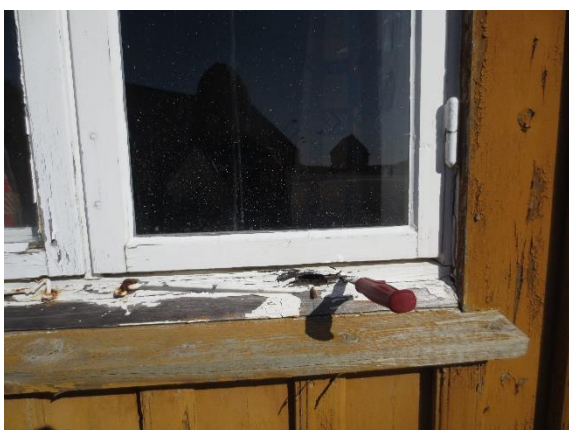
Mange vinduer har råteskader i bunnkarm, selv om vindusrammen er i god stand.
