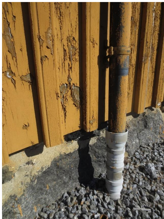
Takrenner og nedløpsrør er ikke undersøkt. Omfattende malingsslitasje.
