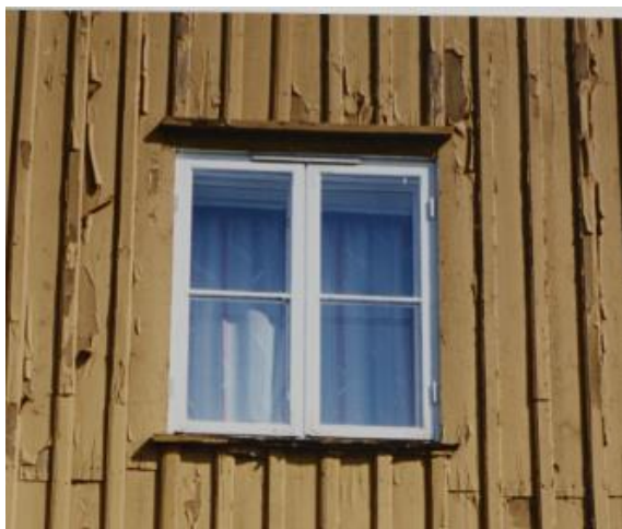
Ytre malingsfilm skallet av, foto 1995. Foto: Riksantikvaren (beskåret)
