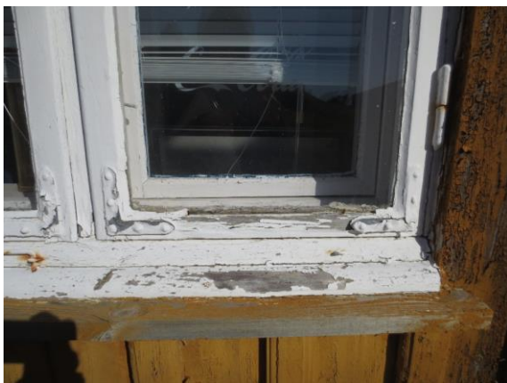
Nyere, enkle vannbrett under vindu (gulmalt). Noen brett er vridd, slik at det er mangelfullt fall på hele eller deler av lengden. Hvitmalt del av bunnkarm/vannbrett er muligens eldre.
