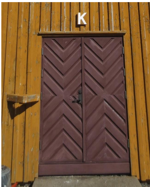
Tofløyet dør midt på fasaden. Bokstavskilt over dør og dørknekt på vegg skal beholdes og males.
