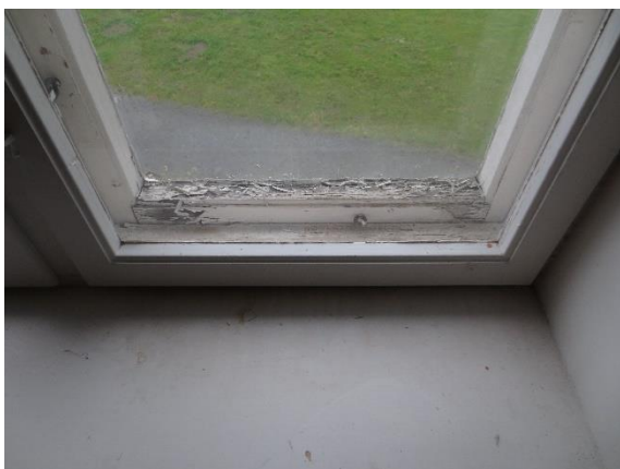
En del vinduer er i relativt god stand. Varevinduene inngår ikke i prosjektet.
