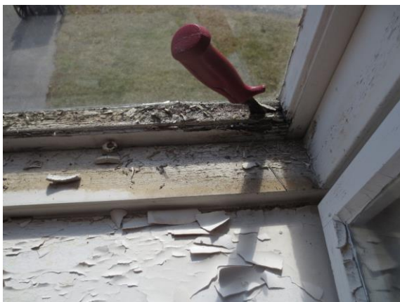
Enkelte vinduer kan se bra ut fra utsiden, men har dype råteskader i bunnrammen og malingsavskalling i smyg.
