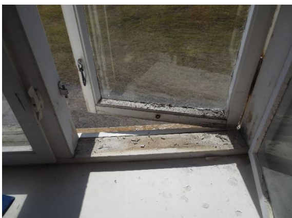
Typisk vindu med enkel ytre ramme. Enkelte hengsler er gjennomrustne og går svært trått, slik at vinduet kun kan åpnes på gløtt.
