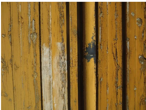
Malingen sitter løst og skaller av på store deler av sørveggen, samt på nedløpsrør.
