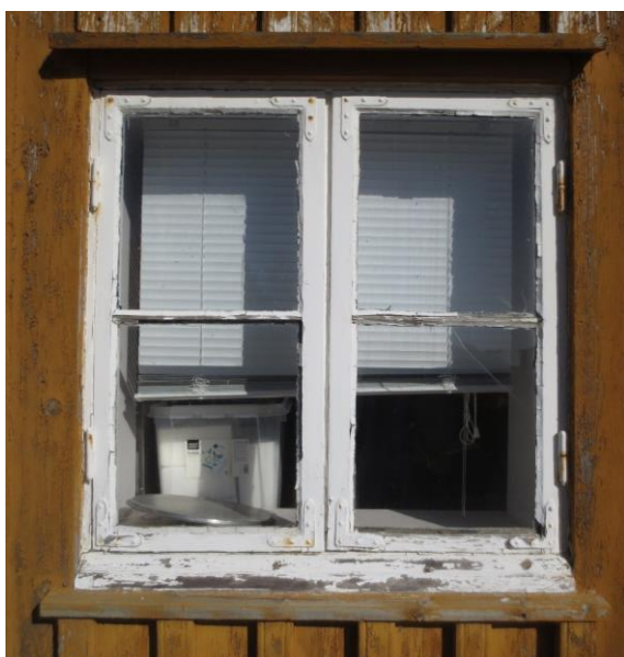
Typisk tofags vindu med enkel ytre ramme og hjørnejern. Eksempel på vindu i relativt god stand, men med slitt maling, kittutfall og rust på hengsler.
