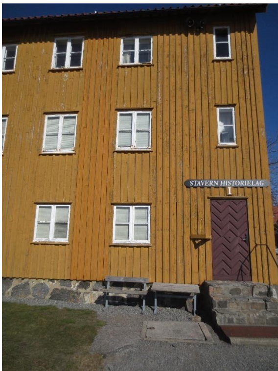
Generelt utsnitt av fasade, med slitt maling og variabel tilstand på vinduer.
