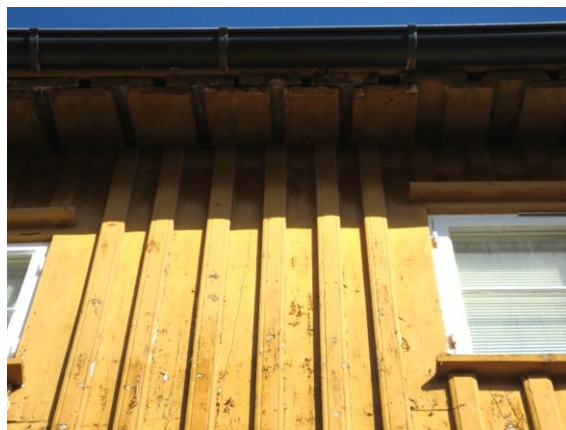
Underside av bordtak har dels gamle bord med lokale råteskader, slitt gulmaling. Inngår ikke i prosjektet.
