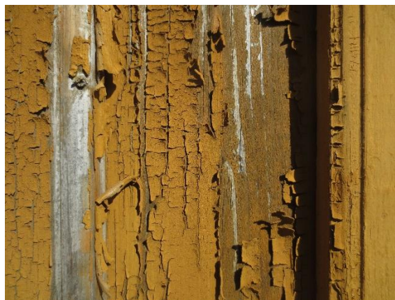
Det er tynne malingslag etter full malingsfjerning i 2005. Malingen skaller kraftig av. Noe grånet trevirke.
