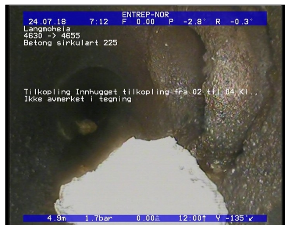
Foto: Tilkopling Innhugget tilkopling fra 02 til 04 Kl., Ikke avmerket i tegning_0714584,96_TK.JPG 4,96m, Tilkopling Innhugget tilkopling fra 02 til 04 Kl., Ikke avmerket i tegning
