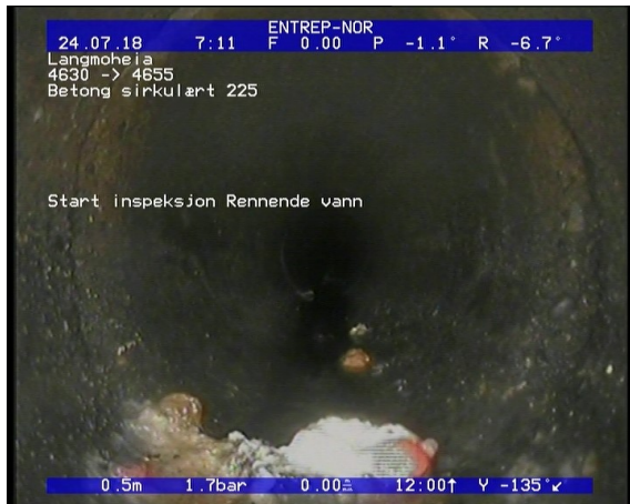
Foto: Start inspeksjon Rennende vann_0713460,5_SI.JPG 0,5m, Start inspeksjon Rennende vann
