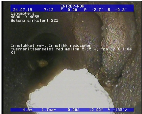
Foto: Innstukket rør, Innstikk reduserer tverrsnittsarealet med mellom 5-15 , fra 02 til 04 Kl._0715.JPG 4,96m, Innstukket rør, Innstikk reduserer tverrsnittsarealet med mellom 5-15 %, fra 02 til 04 Kl.
