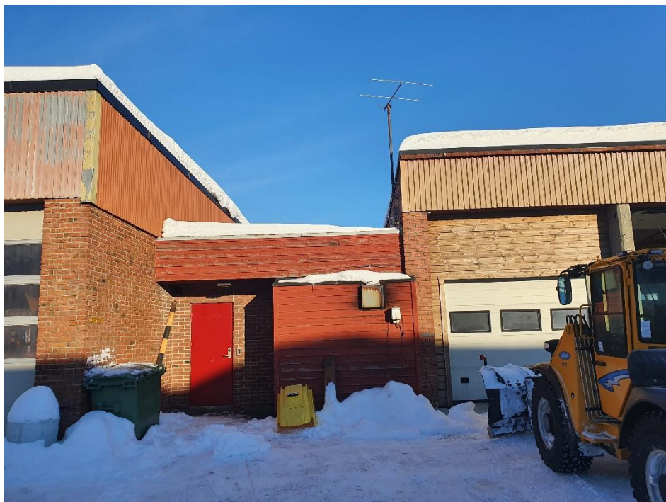
Figur 5 Bilde fra sørvest, mot nord. Den lave kontorfløyen midt i bildet rives til bakkenivå. Verksted til venstre (vest) består.
