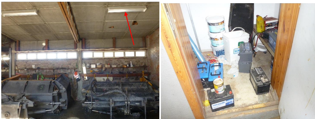
Lysarmatur i tak og batterier i rom 108
