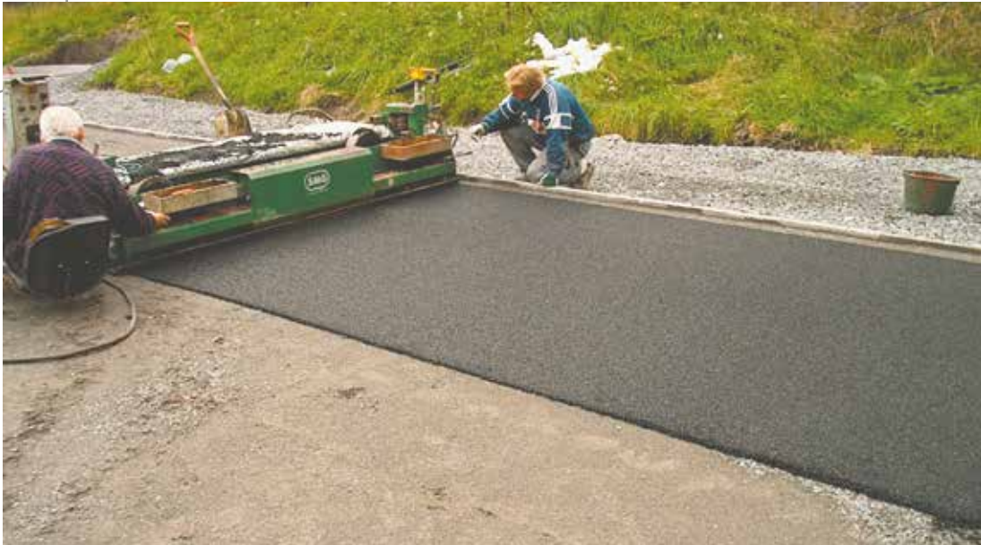
Utlekking av plaststøpt støtdempingssjikt (pad)
