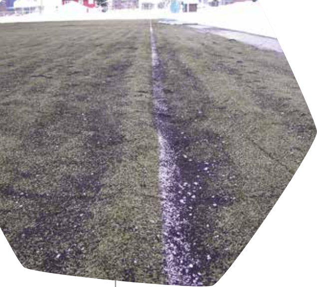
Kjøring på banen med for tungt utstyr under teleløsningen
