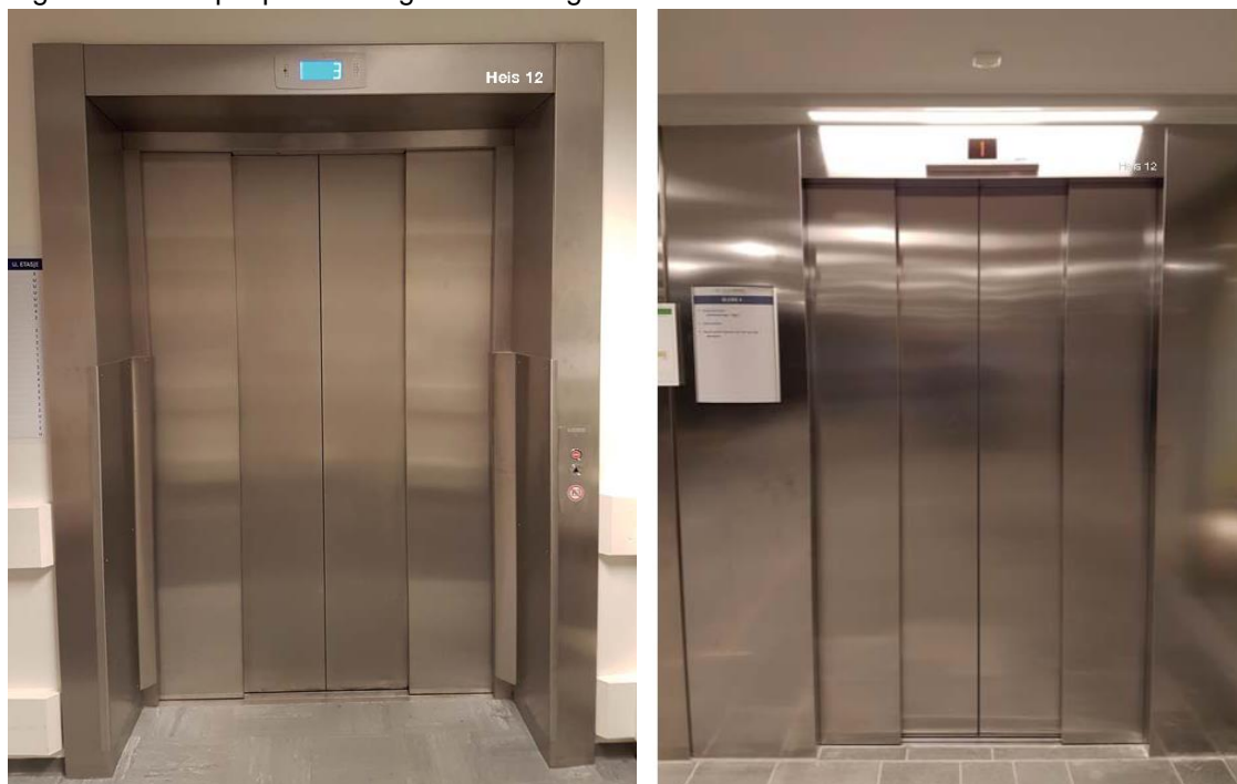
Figur 14 Eksempel på utvendig heismerking
