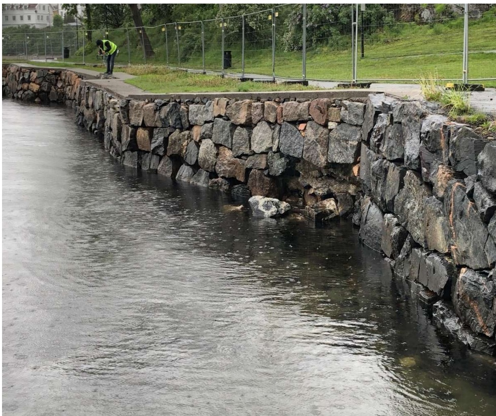
Mur 2, eksempel på skader i muren foran Varmbadet (pr. 0-20) og videre nordover der det er behov for rehabilitering.
