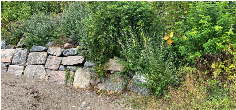
Eksisterende mur. Overgangen mellom eksisterende mur og ny steinkjede må resettes.
