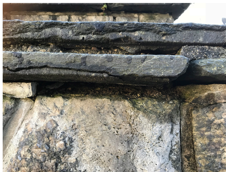
MØRTEL I LUFTETARNENE ER BORTE
