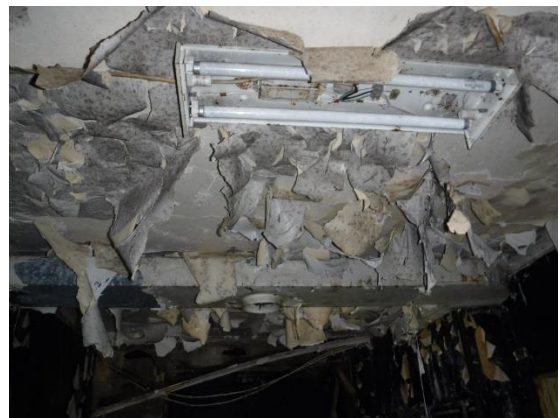
Bilde 7: Tak ved inngang toalettrom
