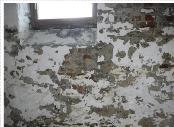
Bilde nr. 8 Avlassende maling og puss i kjeller
