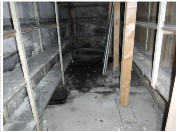
Bilde nr. 14 Fuktoppsamling kjellergulv
