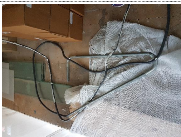
Bilde nr. E 17 Kabel for gammelt ventilasjons anlegg.
