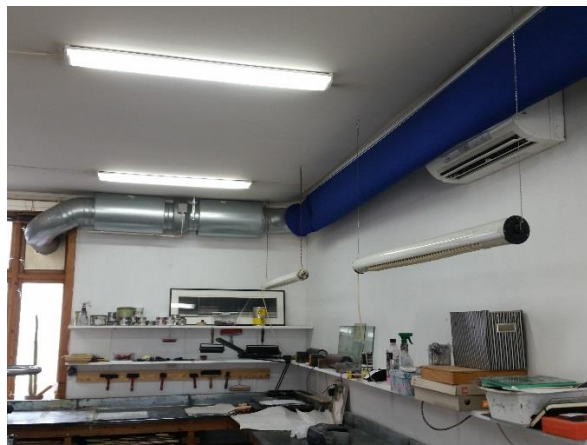
Bilde nr.V97 Avtrekk grafisk verksted & Varmepumpe
