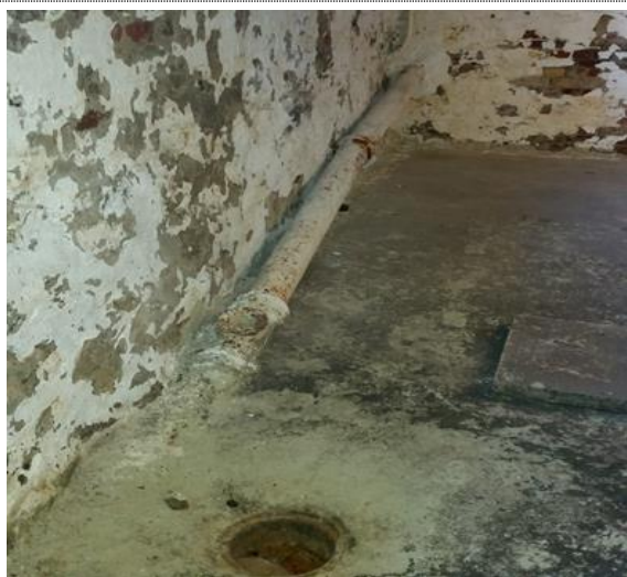
Bilde nr. V1 Støpejerns rør i kjeller
