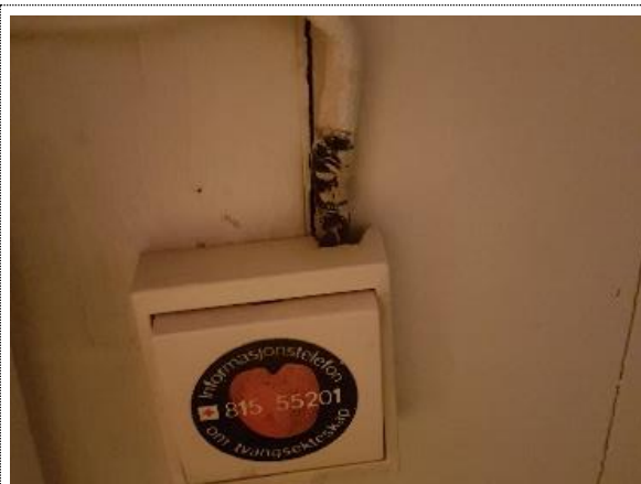
Bilde nr. E 12 Kabelavslutning toalett.
