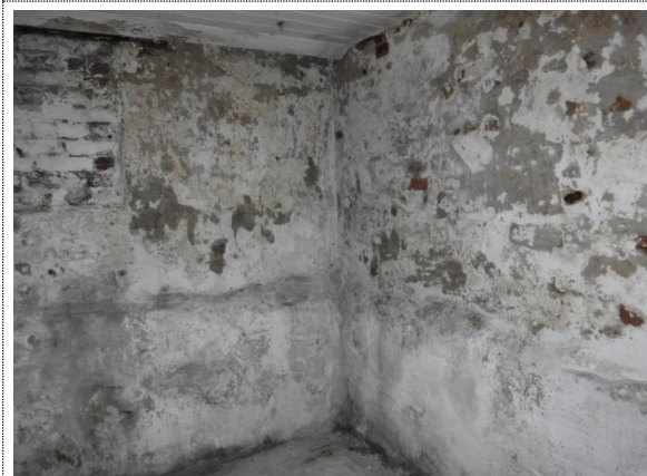
Bilde nr. 10 Avlassende maling og puss i kjeller
