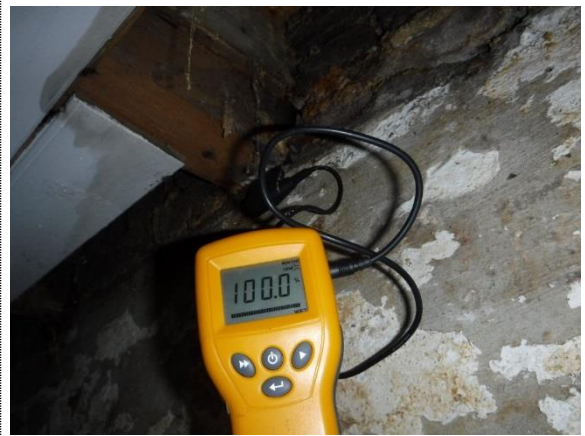
Bilde nr. 12 Fuktmåling i tilfarer, kjeller
