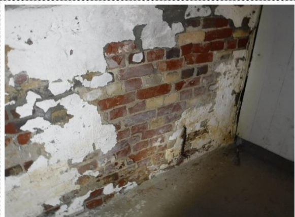
Bilde nr. 9 Avlassende maling og puss i kjeller
