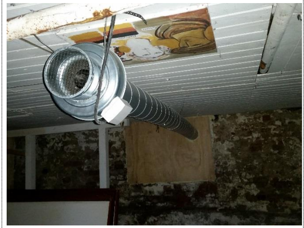
Bilde nr. V8 Avtrekksvifte i kjeller
