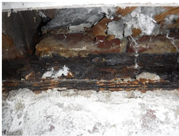
Bilde nr. 11 Korrosjonskadet stålbejelke over gjenmurt vindu
