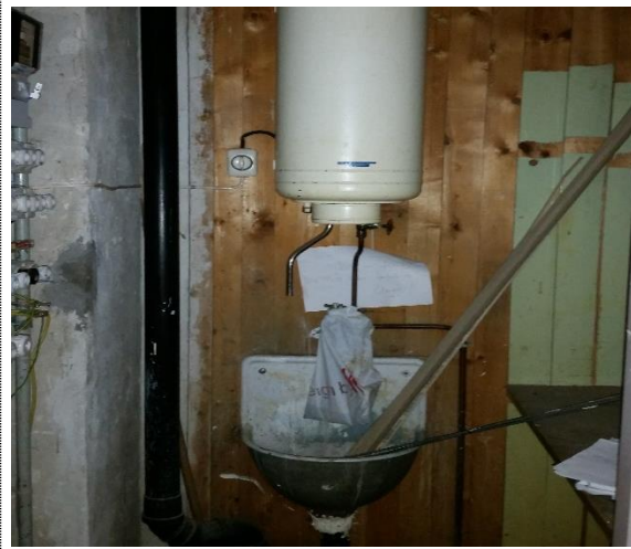
Bilde nr. V 6 Varmvannsbeholder/ utslagsvask utdatert
