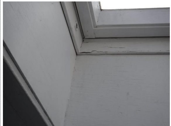
Bilde nr. 16 Spor etter fuktskade takvindu
