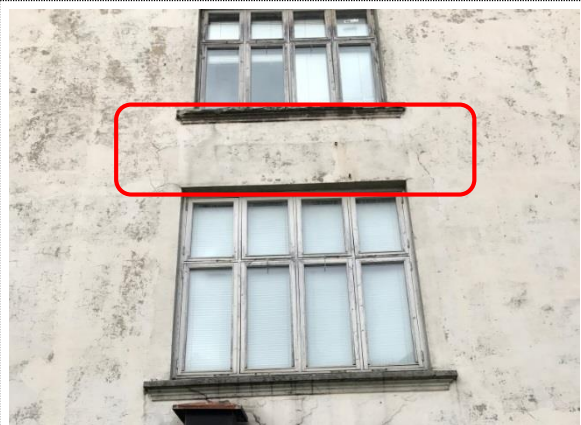
Bilde nr. 7 Riss over vindu
