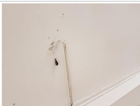
Bilde nr. E5 Eksempel løs kabel.
