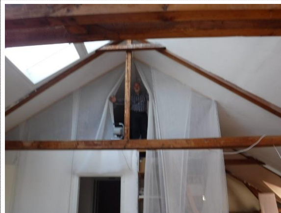
Bilde nr. 32 Manglende sikring repos/hems
