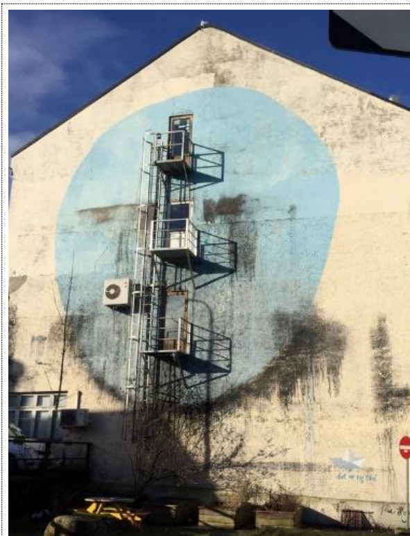
Bilde nr. Br 2 Utvendig stige må erstattes med utvendig trapp. Det er for høyt fra bakkeplan til plan 4 til at det er tillat med stige. Dører må byttes til dører med brannmotstand EI30CSa [B30 S].
