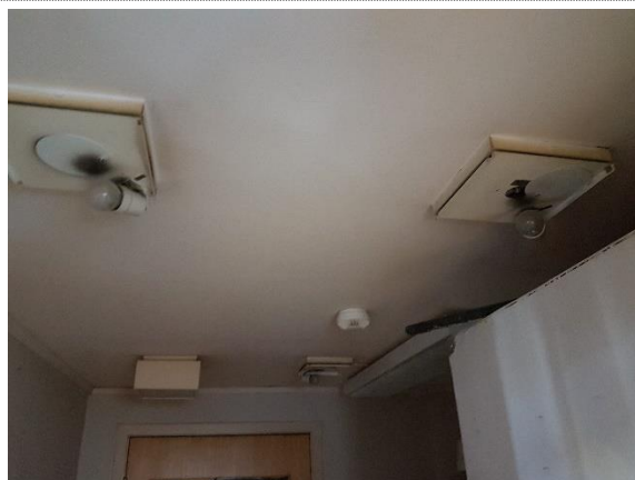
Bilde nr. E3 Ødelagte lysarmaturer.
