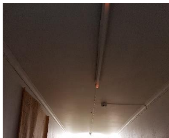
Bilde nr. E 13 Ødelagte gamle armaturer
