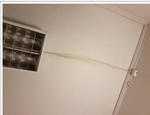
Bilde nr. E6 Eksempel løs kabel.
