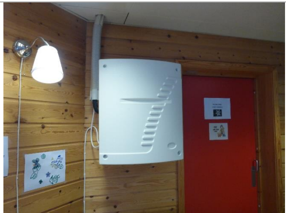
Bilde 48: Ventilasjon med kuldemedie
