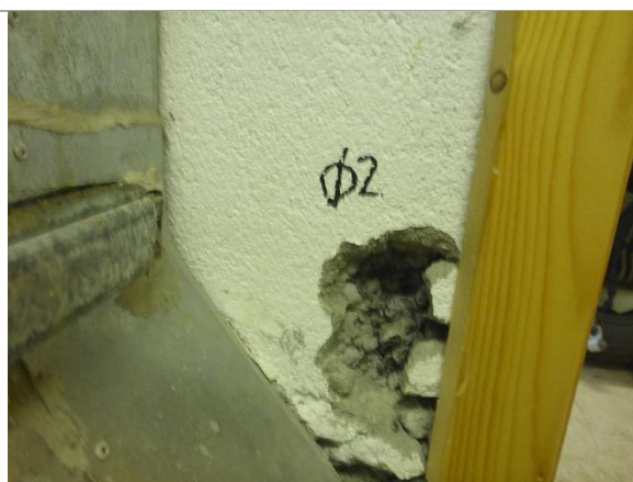
Bilde 6: Murpuss på lecavegg i kjeller.
