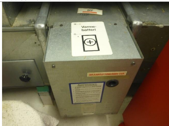
Bilde 35: Ventilasjon i kjeller
