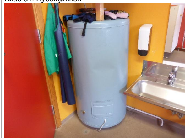
Bilde 53: Varmtvannstank 1. et
