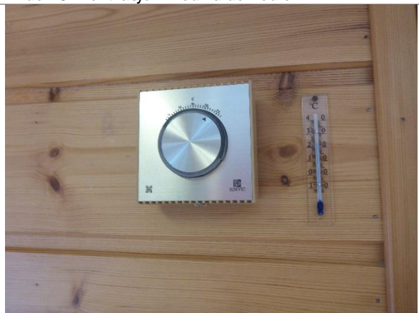
Bilde 50: Termostat varmekabler
