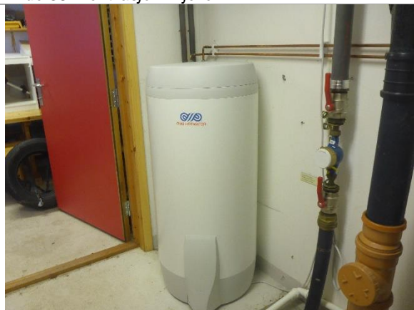
Bilde 37: Varmtvannstank i kjeller
