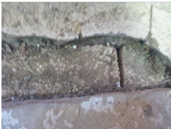
Bilde 24: Hvit isopor i kjellergulv som markisolasjon
