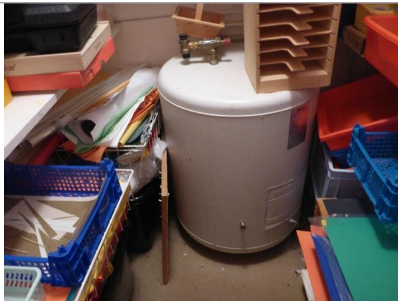
Bilde 47: Varmtvannstank i 1.et
