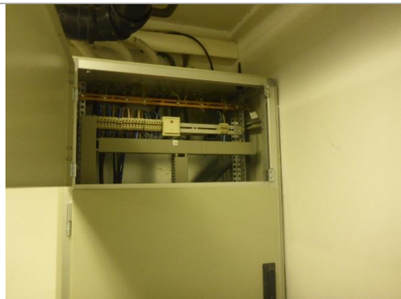
Bilde 40: El-skap i kjeller
