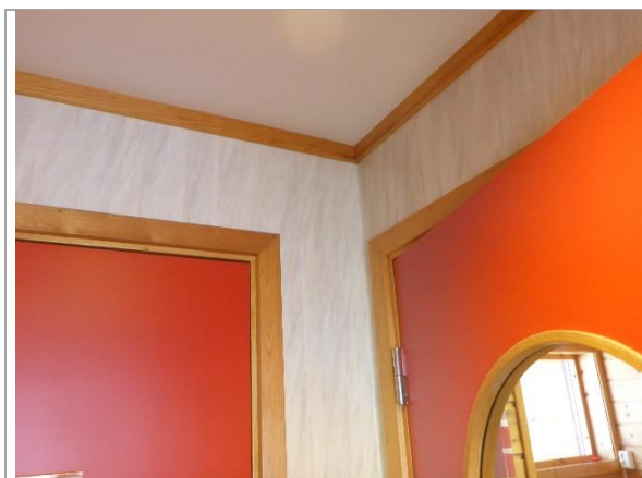
Bilde 19: Vinyltapet på vegger i vindfang
