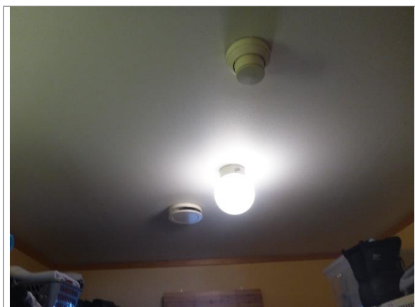
Bilde 41: Røykvarsler, sparepære med armatur
