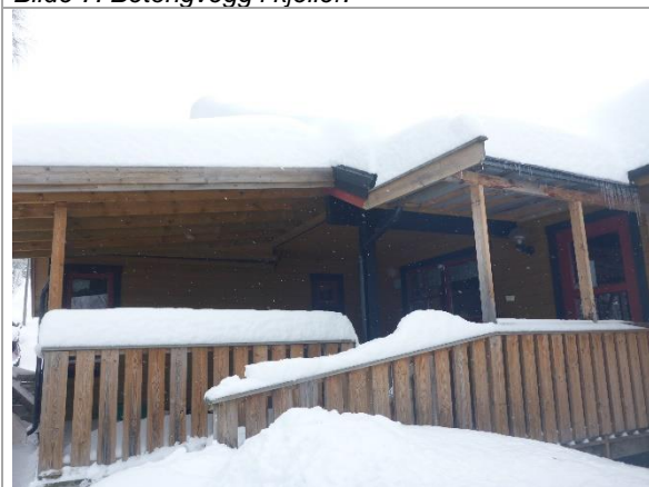
Bilde 9: Impregnert trevirke på veranda.
