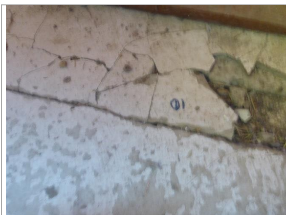
Bilde 5: Betong gulv i kjeller. OBS farlig avfall kobber!
