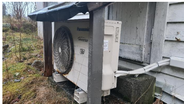
Bilde 14 – Varmepumpe, utedel.
