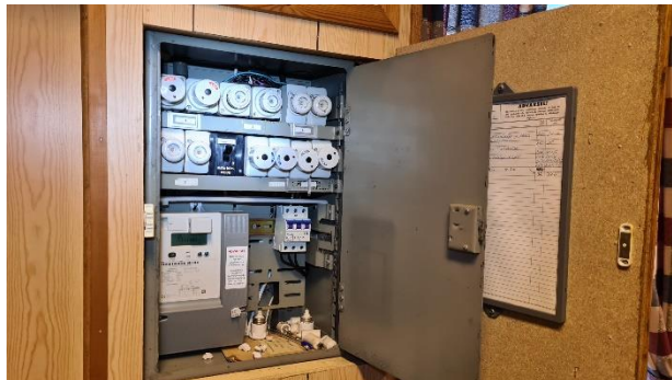
Bilde 20 – Fordelingsskap på loft.
