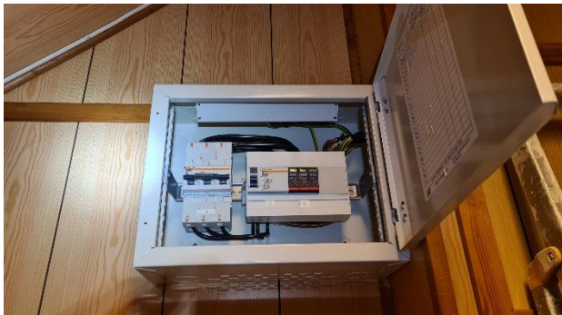
Bilde 19 – Inntaksskap på loft.
