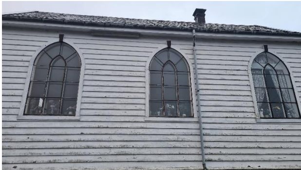
Bilde 5 – Østfasaden, med noe flassende maling.
