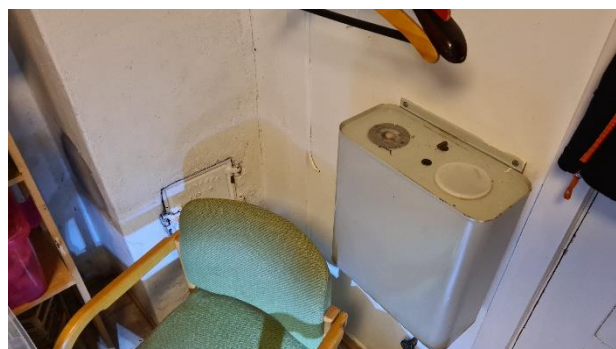
Bilde 16 – Dagtank på kjøkkenet, med rør til oljekamin.
