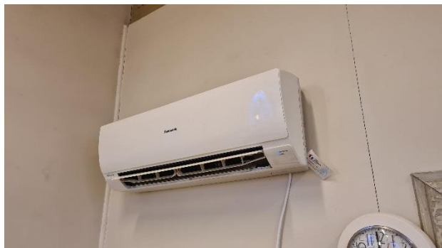
Bilde 13 – Varmepumpe, innedel i sal.
