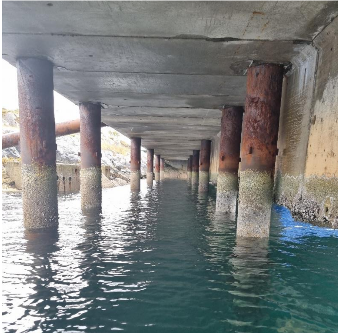
Figur 3-1: Stålrørspelene under tilleggskai. Kaias horisontalforankring kan sees til venstre i bildet. Bildet er tatt av Multiconsult i forbindelse med grunnundersøkelsene.
