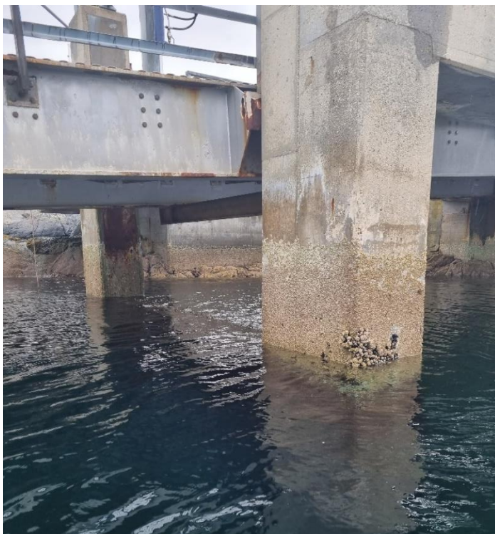
Figur 3-2: Bilde av betongsøylene under heisetårnet. Bildet er tatt av Multiconsult i forbindelse med grunnundersøkelsen.
