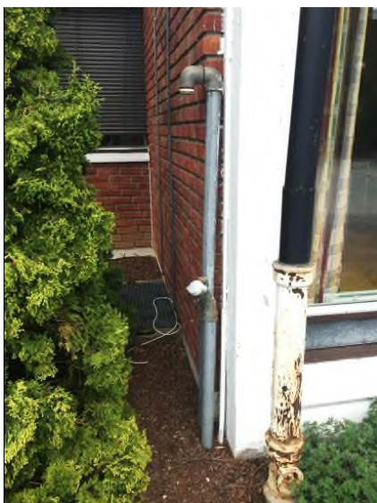
Figur 1 Påfyllingsrør for nedgravd oljetank.
