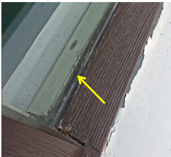
Figur 1 Gummilist utside gamle isolerglassvinduer er farlig avfall.
