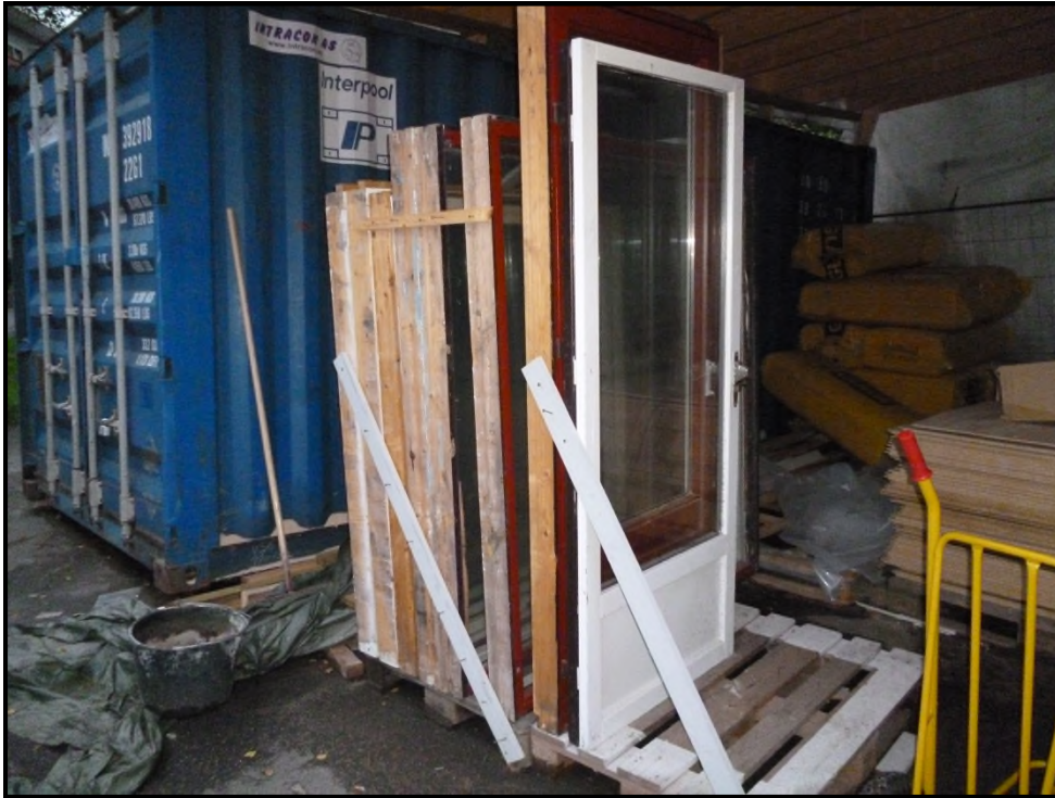
Figur 3 Slik kan vinduer og balkongdører klargjøres for transport.
