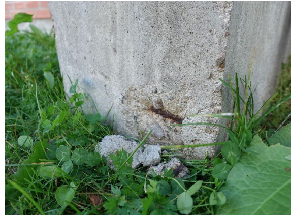
Figur 5-6: Karbonatisert betong fuktes rundt bakken og armeringen korroderer.
