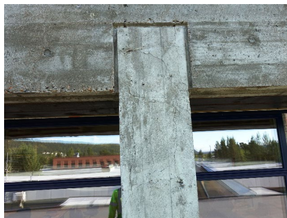
Figur 5-2: Pilar K5, armering registrert 20/12 mm bak oppsprekking.
