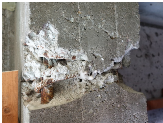
Figur 5-7: Søyle M2 med støpesår og synlig armeringsjern.
