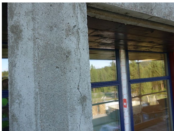
Figur 5-1: Pilar M9, armering registrert 20 mm bak vertikal sprekk.
