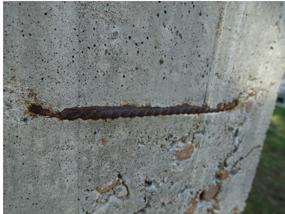
Figur 5-5: Synlig armeringsbøyle med overflatekorrosjon.
