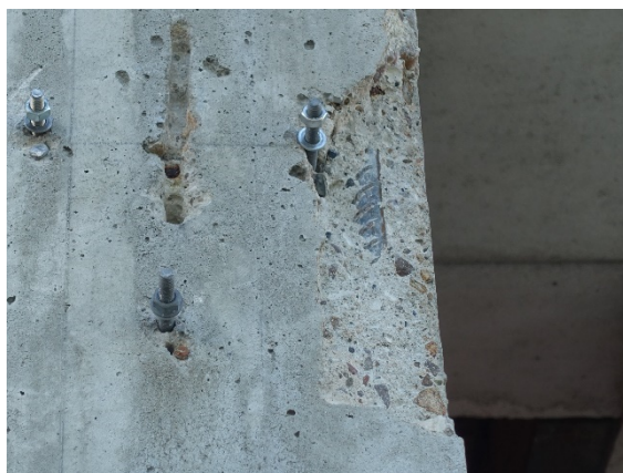
Figur 4-1: Opphugging på pilar K9, det er lite synlig korrosjon på armeringen.
