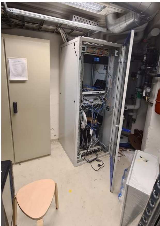
Figur 1: Eksisterende rack i rom 01-026
