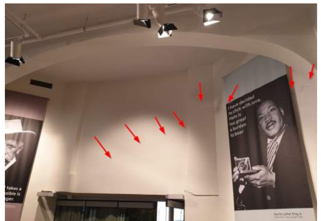
Figur 14 – Bilde 2 - Rissmønster tyder på bevegelse under opplegg for bjelke (06.09.2021)
