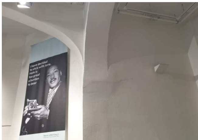
Figur 13 – Bilde 1 - Overgang mellom betongkonstruksjon og antatt murverk risser, mulig horisontalforskyvning (06.09.2021)
