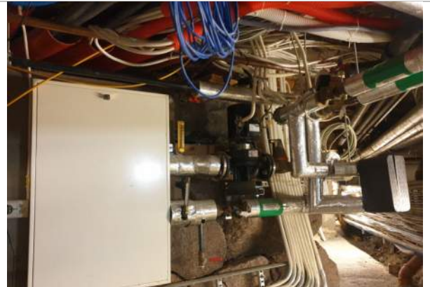
Figur 18 - Bilde 6 - Omfattende tekniske føringer gjennom vegg i aktuelt område kan ha medvirket til ustabilitet. Lastnedføring sikres
