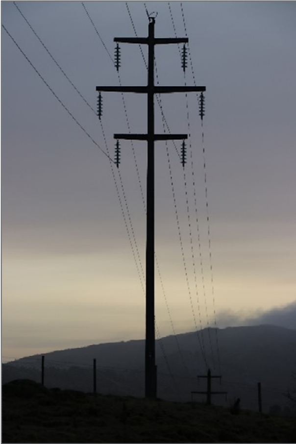
Figur 1. Dobbeltkurs 66 kV betongmast mellom Ølen og Våg.
