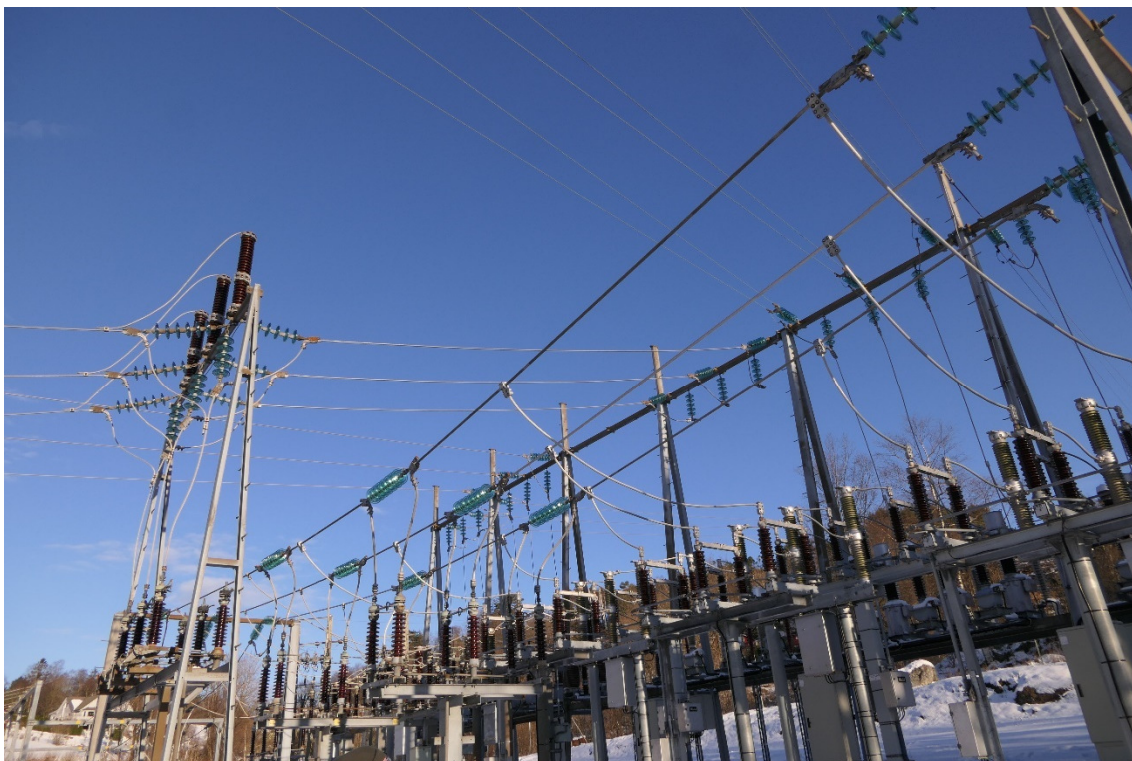
Illustrasjon: 66 kV stålstativ til venstre i bildet, med arrangement som skal demonteres ved Våg transformatorstasjon.
