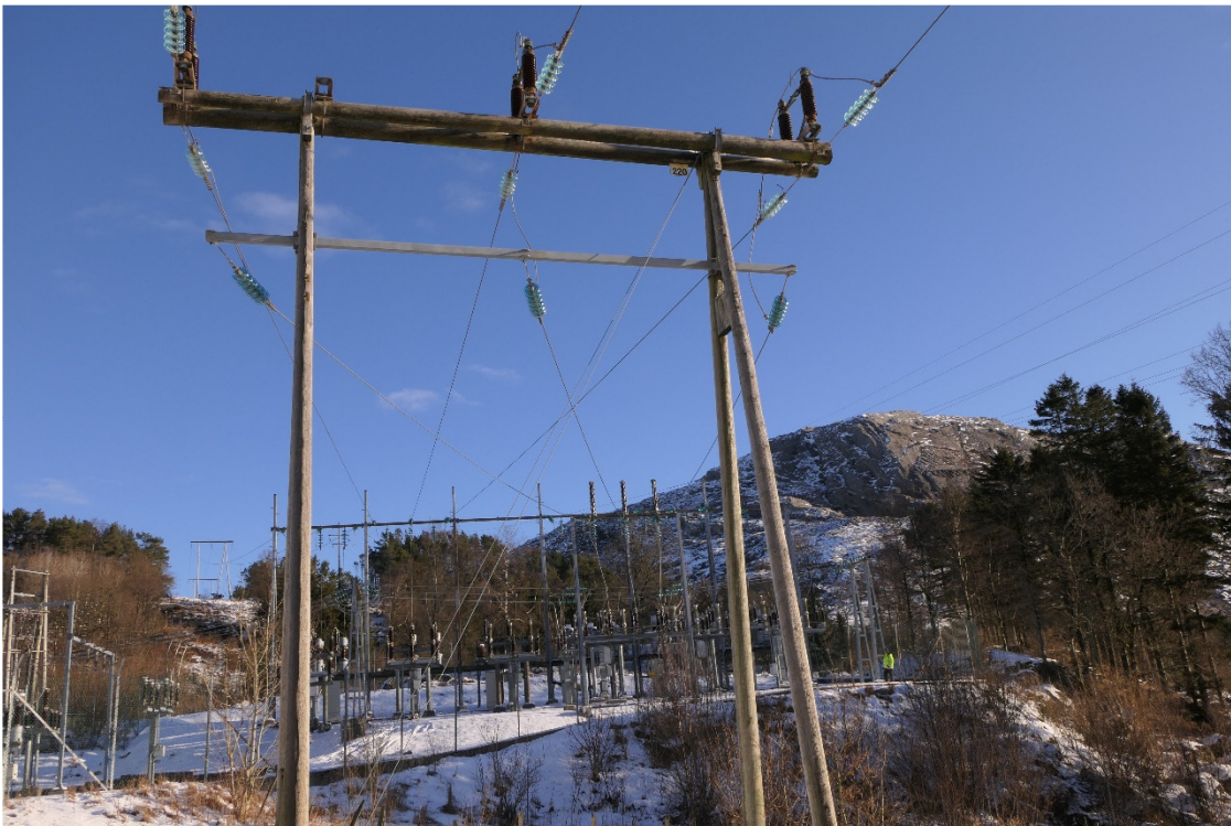
Illustrasjon: 66 kV tremast 220 ved Våg transformatorstasjon, med skillebrytere som skal demonteres.
