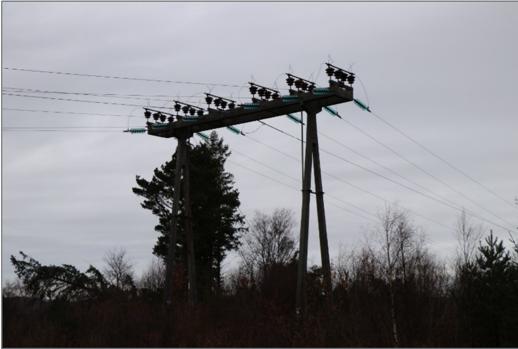
Figur 2. Mast 233 og 298. Dobbelkurs 2A betongmast med planoppheng.
