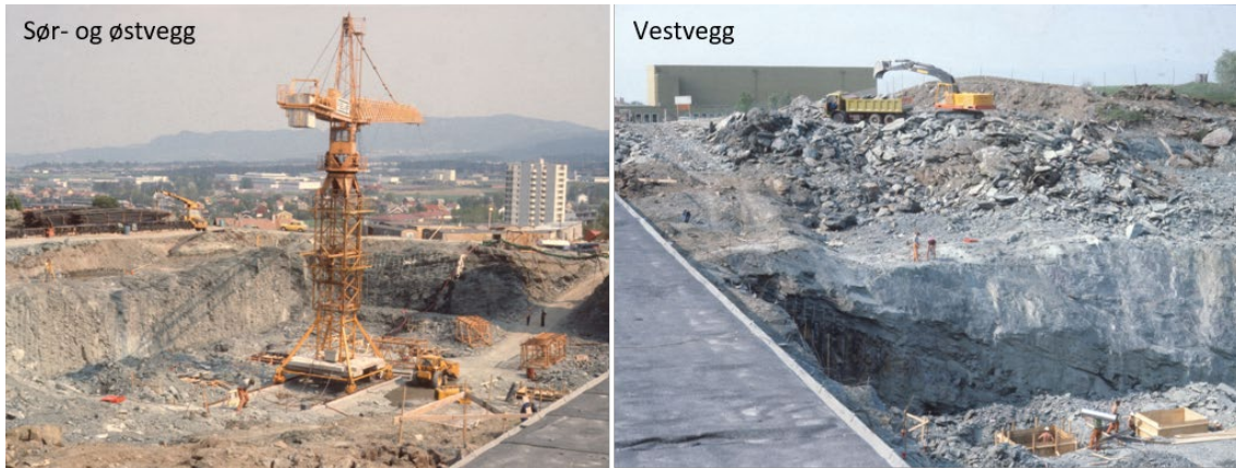
Figur 7. Bilder fra bygging av bølgebasseng, datert 1979. Legg merke til tydelig utglidning langs glatt sprekk med fall på 50-60 grader mot øst i bildet til høyre. Sprekken ligner på sprekker med klorittbelegg, observert i utborede kjerner. Bildet til venstre viser berg som tilsynelatende står stabilt uten bergsikring.
