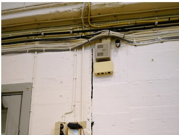
Figur 30: Eldre kabling utbygd over tid
