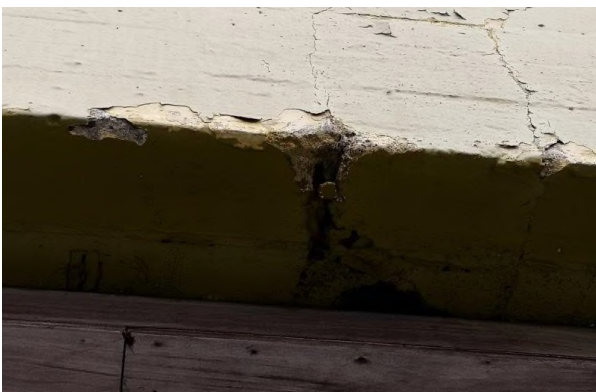
Figur 6: Sprekker/riss i betongbæring over utsparing
