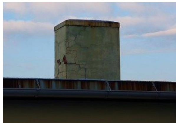
Figur 23: Tegl pipe i dårlig forfatning
