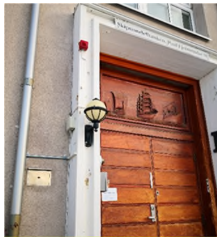
Figur 14: Flott ytterdør fortjener vedlikehold
