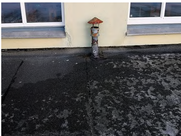
Figur 18: Gamle tak, tekking og luftehatter
