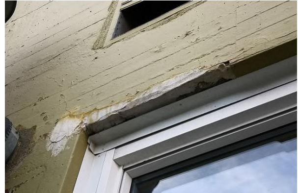
Figur 7: Mulig strukturelle skader i betong
