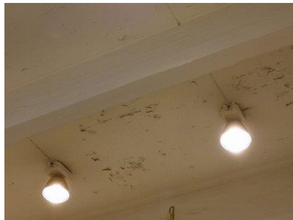
Figur 21: Malingsflask i dekke yttertak
