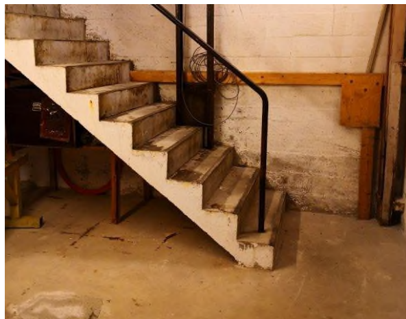
Figur 3: Fuktsug, mulig armeringskorrosjon dekke
