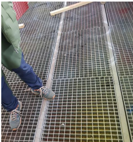
Bilde: Ristgulvet inne i lakkboksen.
