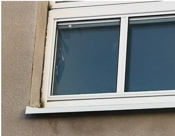
Figur 12: Manglende tetting smyg/vindu; fuktskader og bom i puss på renoverte fasader
