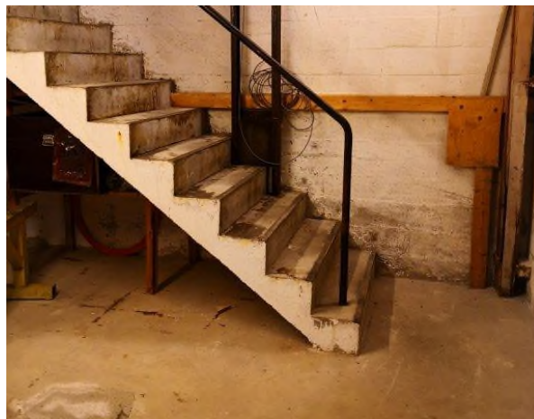
Figur 3: Fuktsug, mulig armeringskorrosjon dekke
