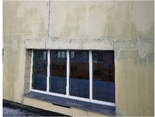
Figur 9: Fasade sørvest i dårlig forfatning
