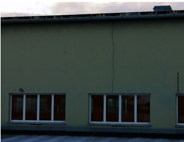
Figur 10: Sprekk i betong, fasade nordvest
