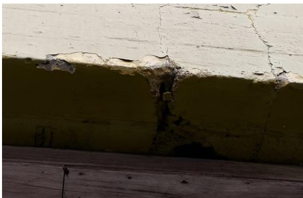
Figur 6: Sprekker/riss i betongbæring over utsparing
