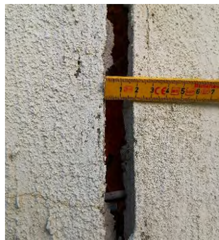
Figur 11: Stor sprekk i puss/betong, fasade sørvest
