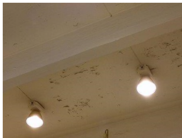
Figur 21: Malingsflask i dekke yttertak
