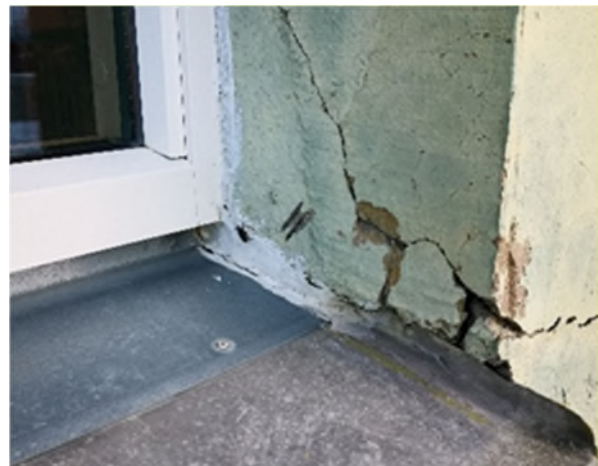
Figur 10: Omfattende pusskader i smyg. Dårlig løsning
