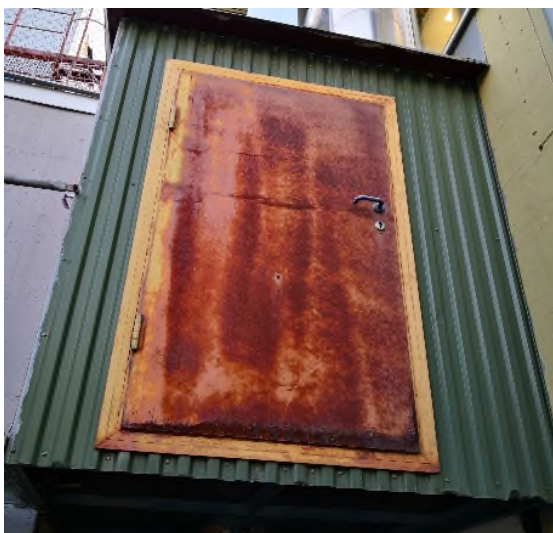
Figur 13: Omfattende korrosjon "teknisk dør"
