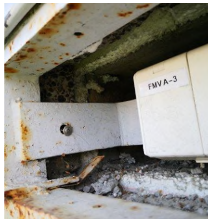
Figur 33: El-uttak i gamle veggventiler
