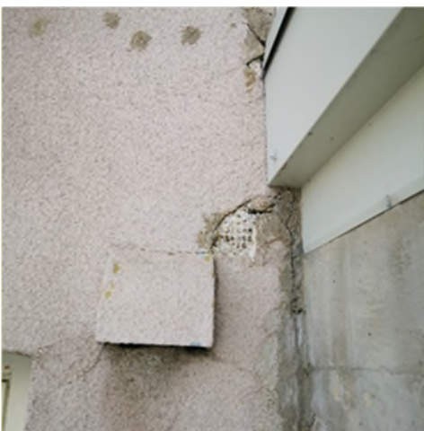
Figur 11: Pusskader fasade sørvest
