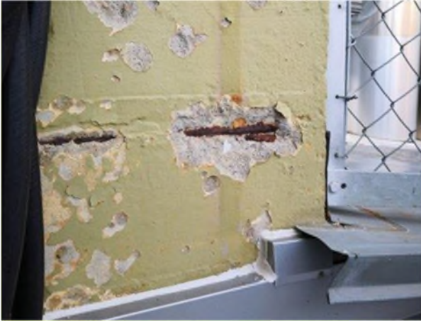
Figur 6: Avskaling og synlig armering
