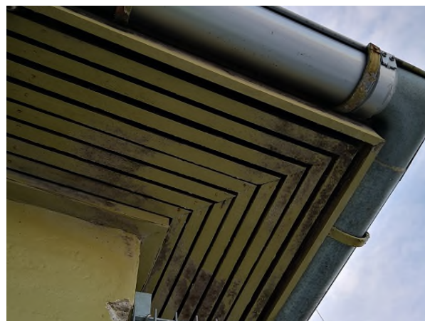
Figur 20: Raftekasse med fuktmerker
