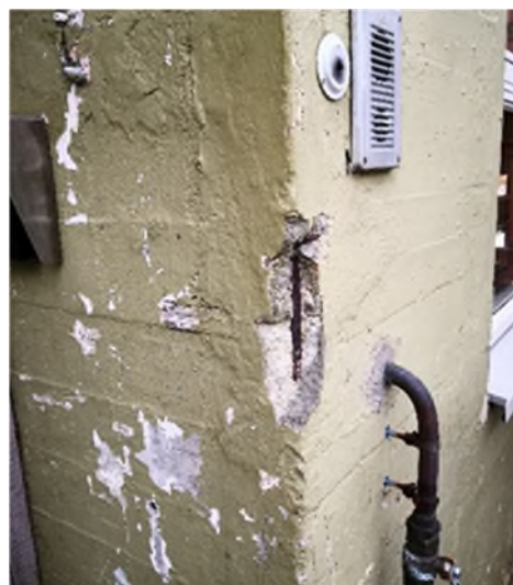
Figur 15: Betongskader ved port
