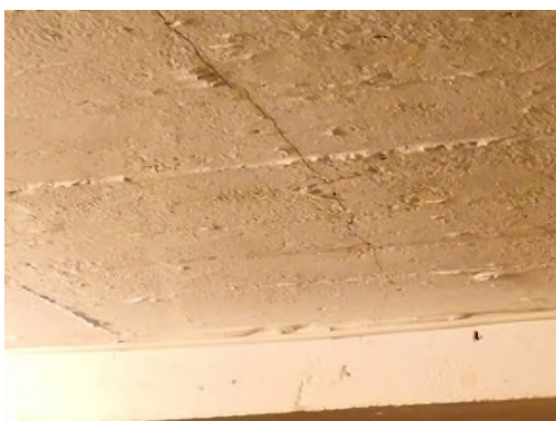
Figur 16: Riss/sprekk i dekke mot kjeller
