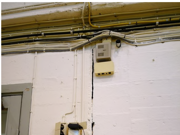
Figur 30: Eldre kabling utbygd over tid
