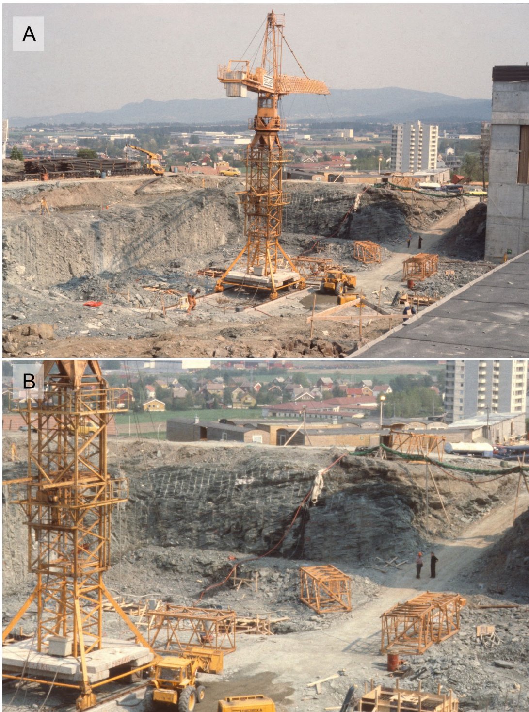
Figur 6. Bilder fra bygging av skipsmodelltank, datert 1979. A: Bergvegg i nordøst og sørøst. B: Bergvegg i sørøst. Bergveggene i nordøst og sørøst er tilsynelatende stabile uten tung bergsikring. Se Figur 4 for plassering i forhold til prosjektert byggegrop.
