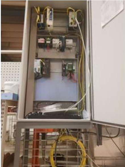
Tavle for bølgemåling/instrumentering
