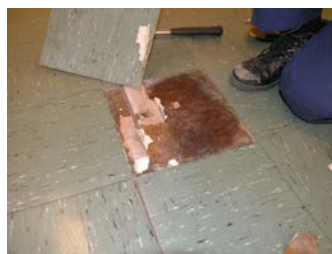
Gulvbelegg med asbest
