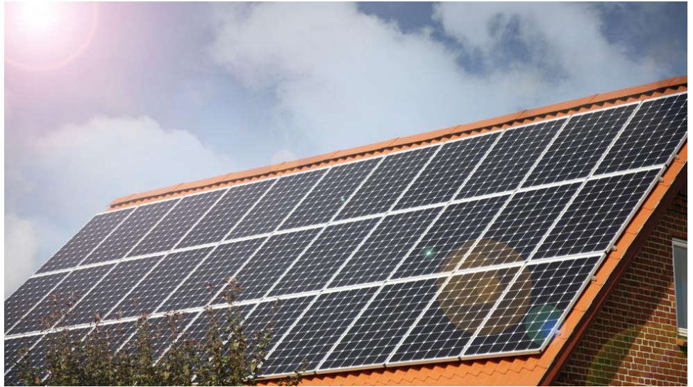
Figur 3-12 Solcellepaneler montert på vanlig tak.
