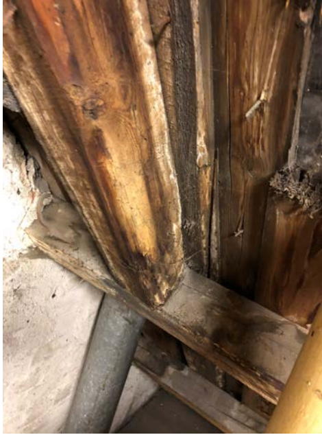
Bilde 2: Tak langs pipe på loftet
