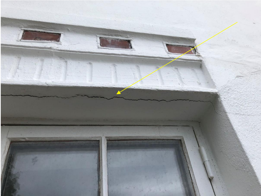
FIGUR 6. GUL PIL VISER HVORDAN SEMENTSTERK PUSS HA LØSNET FRA UNDERLAGET DER DET ER BOM MELLOM BÆRING OG PUSS OVER VINDUET. 2. ETG. GAVL, VESTVEGG. (FOTO: MUR OG MER, JUNI 2020).
