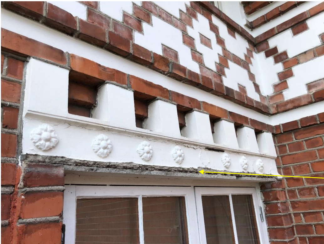
FIGUR 7. GUL PIL OG DETALJBILDE VISER KORROSJON I DRAGERENS OVERFLATE. UTVIDELSEN I MATERIALET HAR FØRT TIL AT ALL SEMENTPUSS HAR FALT AV. ØSTVEGG. 3. VINDU FRA SYD. (FOTO: MUR OG MER, JUNI 2020).
