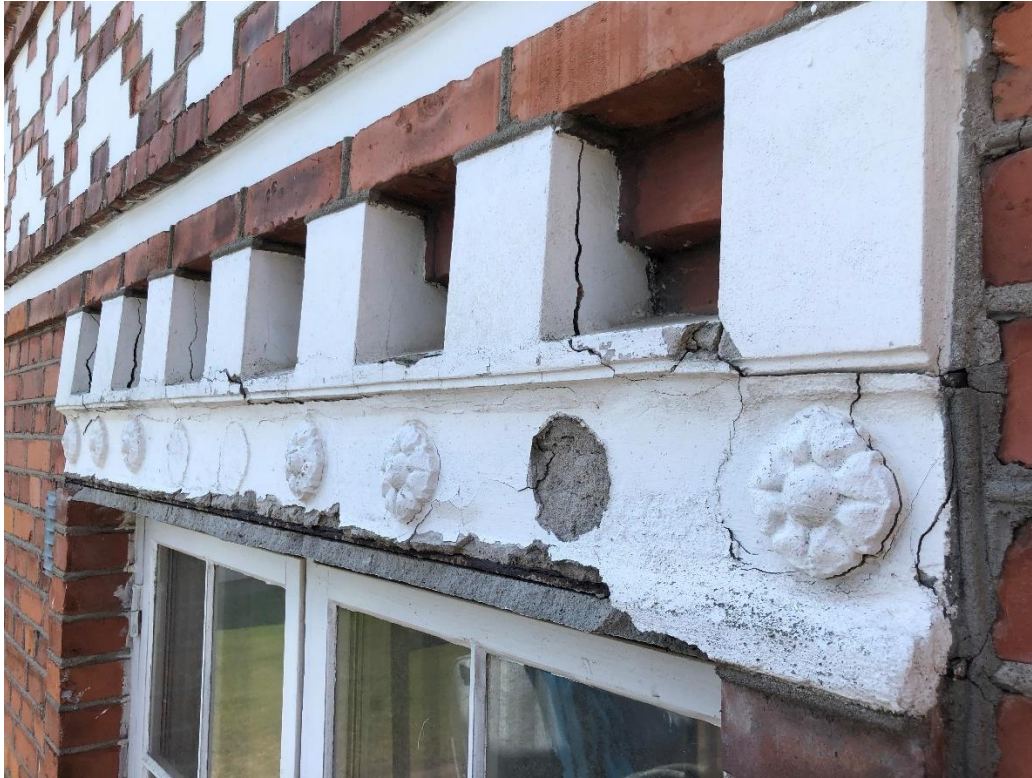
FIGUR 5. PUSS OG MULIGVIS UNDERLIGGENDE TEGL ER SKADET I TILKNYTNING TIL DRAGERNE OVER VINDUS- OG DØRÅPNINGENE. SPREKKMØNSTERET VITNER OM BÅDE HORISONTAL OG VERTIKAL TRYKKPÅVIRKNING DER HØY VANNINNTRENGNING HAR FØRT TIL RUST OG UTVIDELSE AV UNDERLIGGENDE MATERIALER. (FOTO: MUR OG MER, JUNI 2020).
