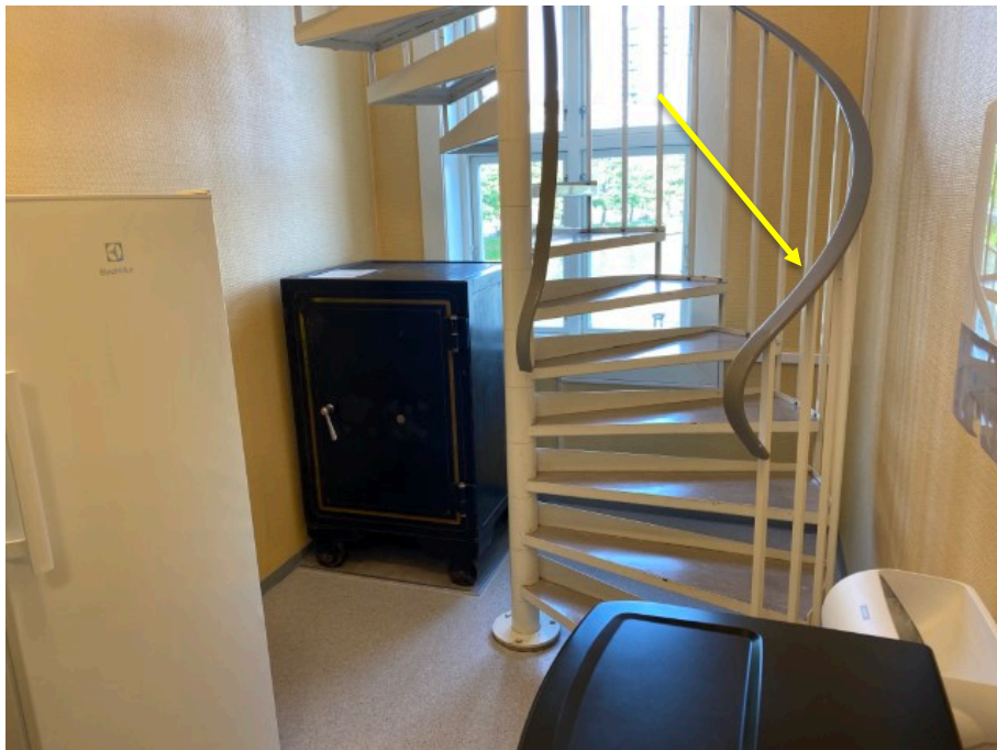
Figur 22 – Eldre lister på rekkverk inneholder ftalater over grenseverdier for farlig avfall
