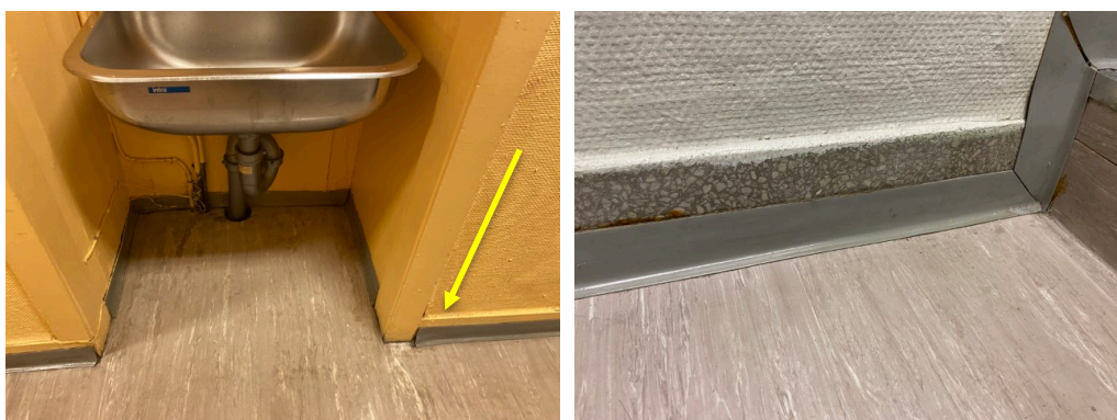
Figur 21 - Eldre vaskelister inneholder ftalater over grenseverdier for farlig avfall
