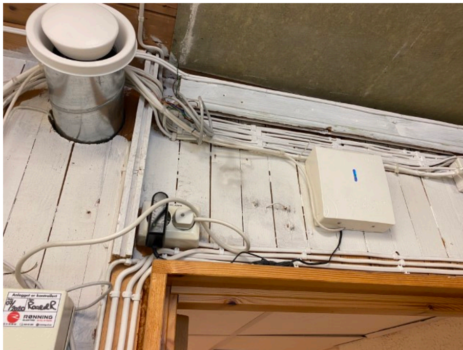
Figur 26 – Det er registrert endel EE-avfall i bygget, fra ulike perioder.
