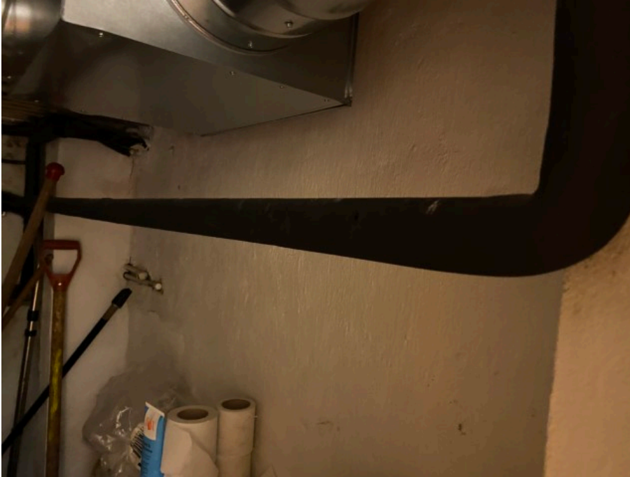
Figur 24 - Cellegummi rørisolasjon kan inneholde bromerte flammehemmere over grenseverdier for farlig avfall.
