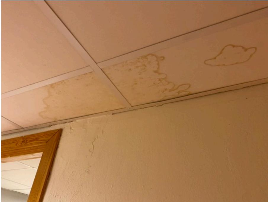
Figur 27 – Vannskade i himling i underetasjen.
