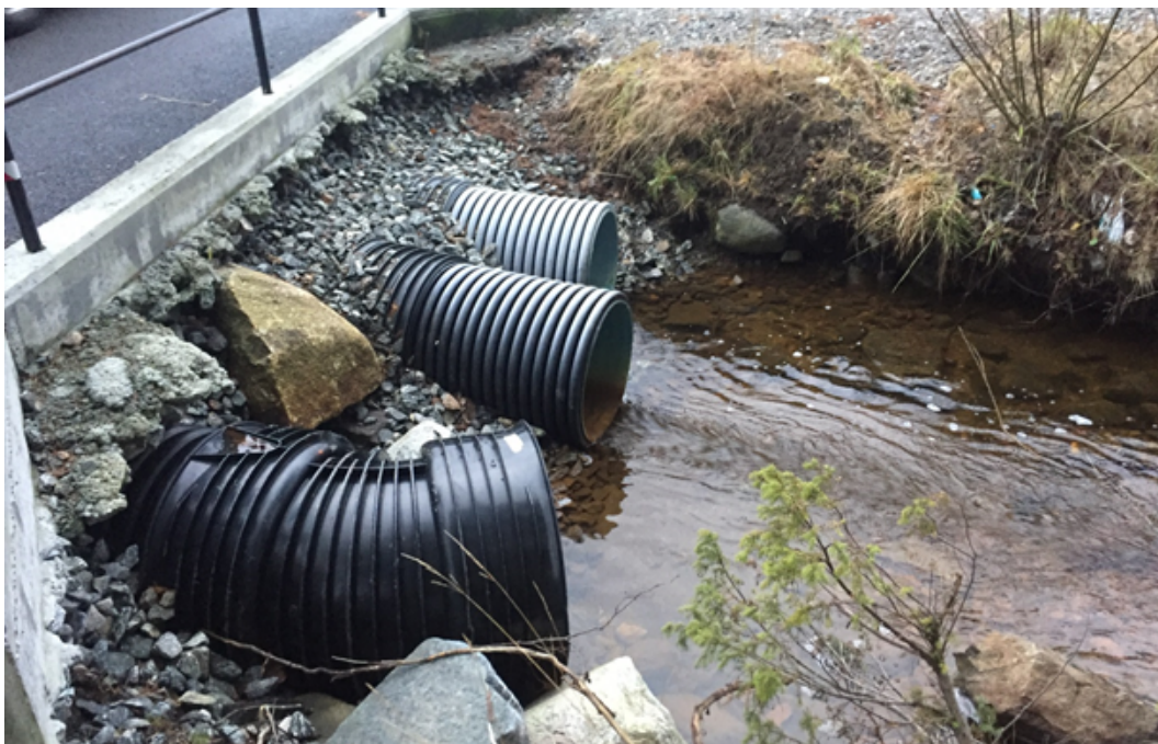
Figur 6 Utløp fra rør under Vasstrandvegen. Også på denne siden bør omfyllingsmassene rundt rørene og vegoverbyggingen sikres mot utvasking
