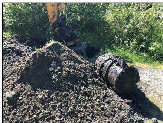
Figur 18 PG29. Sandige fyllmasser. Ståltønne innblandet i massene.
