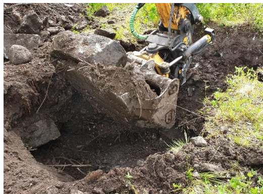
Figur 24 Sjakt PG8. Blanda fyllmasser som inneholder blant annet betongelementer og asbestrør.
