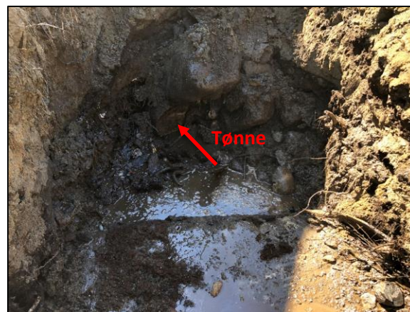
Figur 12 Sjakt PG20. Avfallsblandede masser under et avrettingslag av sand. Enden av en ståltønne kan observeres langs gropas vegg.
