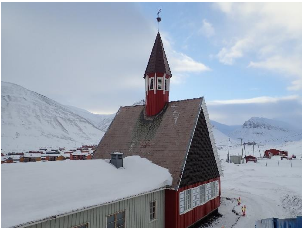
Bilde 4: Asbestholdige takplater på mellombygg
