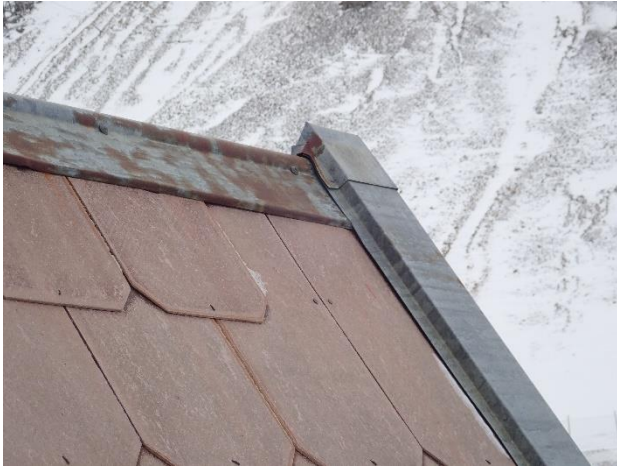
Bilde 2: Asbestholdige takplater
