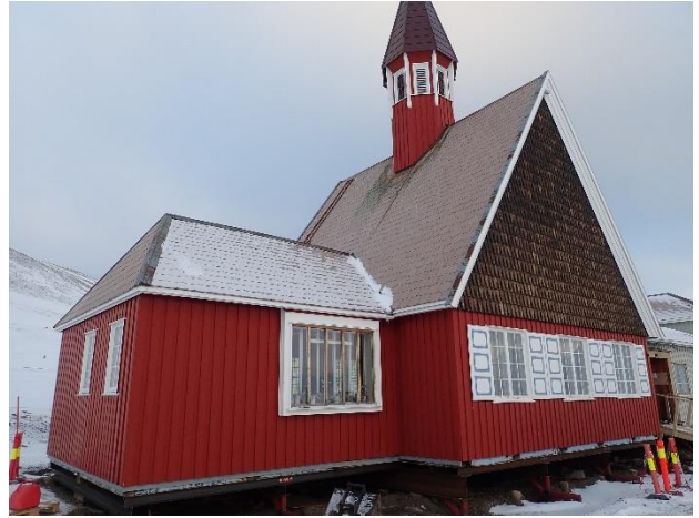
Bilde 3: Asbestholdige takplater på kirke
