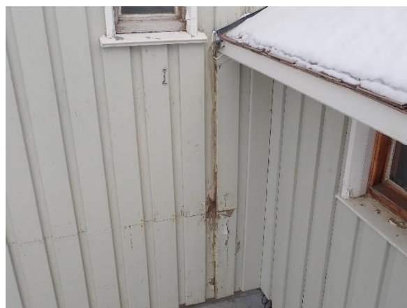
Bilde 20: Vinkelrennebeslag med ising og skade på kledning
