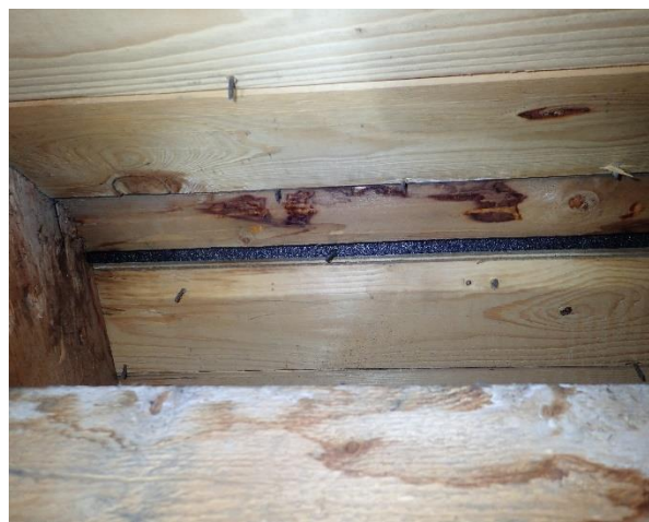
Bilde 16: Innsiden av mønet ved boligdelen med noen eldre fuktskader
