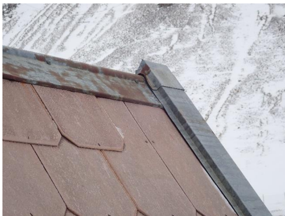
Bilde 7: Manglende plate på taket nedenfor tårnet, på takflaten mot nord.
