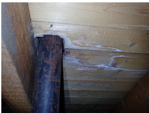
Bilde 33: Gjennomføring på tak (mot øst) med eldre fuktskade
