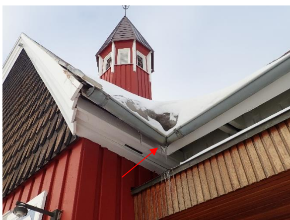
Bilde 21: Takrenne over inngang til kirken, med skade i innvendig hjørne
