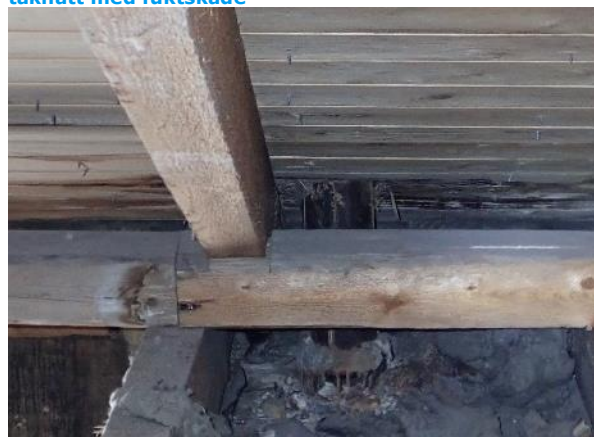
Bilde 36: Gjennomføring i nærheten av yttervegg uten takhatt med fuktskade
