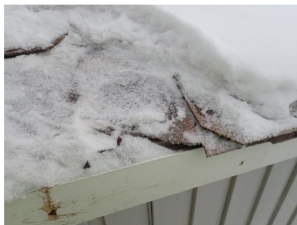
Bilde 10: Skader på takplater på mellombygget
