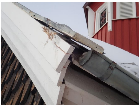
Bilde 13: Beslag med inngangspartiet, med en skade
