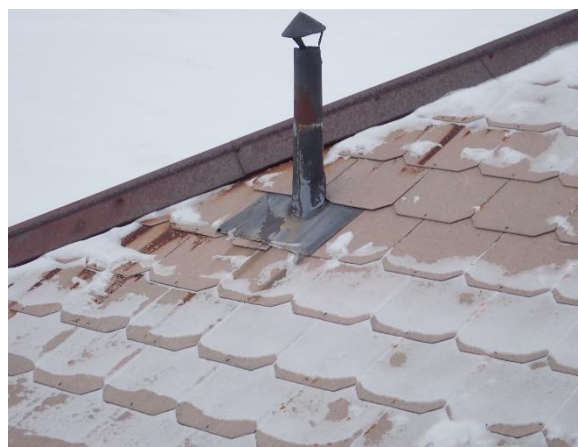
Bilde 28: Avtrekkshatt på sørsiden av boligbygget
