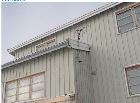
Bilde 24: Takrenne med utkast på ene siden av takrennen
