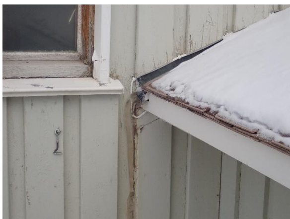
Bilde 19: Vinkelrennebeslag med ising og skade på kledning
