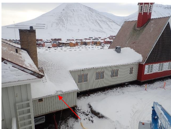
Bilde 9: Område med skader på takplater på mellombygget
