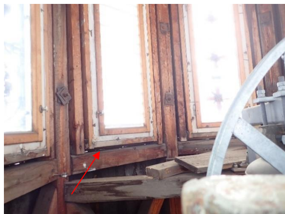
Bilde 50: Vinduer i klokketårn uten tilstrekkelig tetting i overgangene
