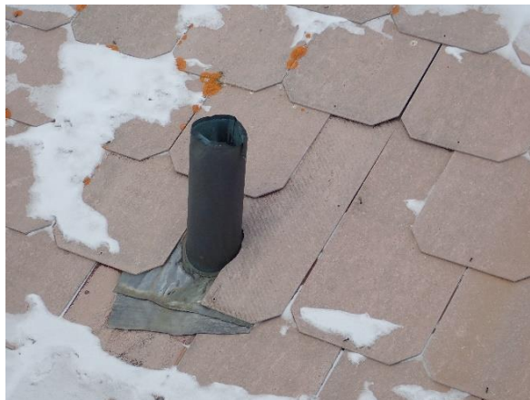
Bilde 8: Manglende plate over gjennomføring og knust plate
