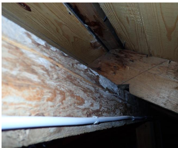
Bilde 15: Innsiden av mønet ved boligdelen med noen eldre fuktskader
