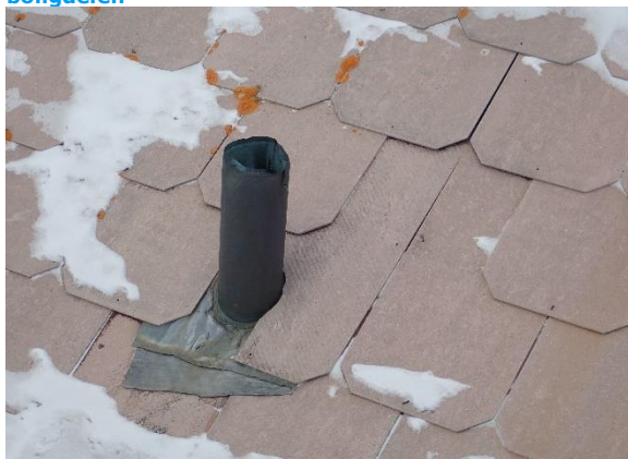
Bilde 29: Avtrekkskanal knyttet til bad uten hatt
