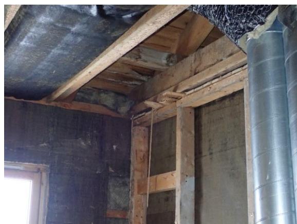
Bilde 34: Gjennomføring i nærheten av yttervegg uten takhatt med fuktskade
