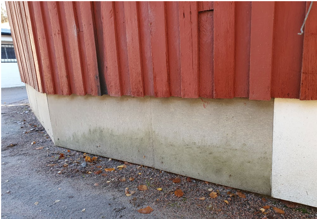
Prøve 1 – Plater på ytterside av ringmur – Prøve påviser asbest
