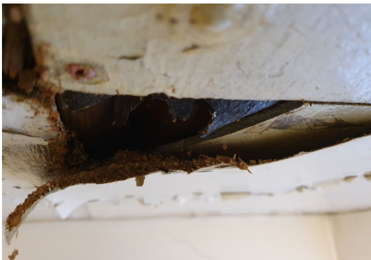
Prøve 2 - Plater tak, brukt til reparasjon – Prøve påviser asbest
