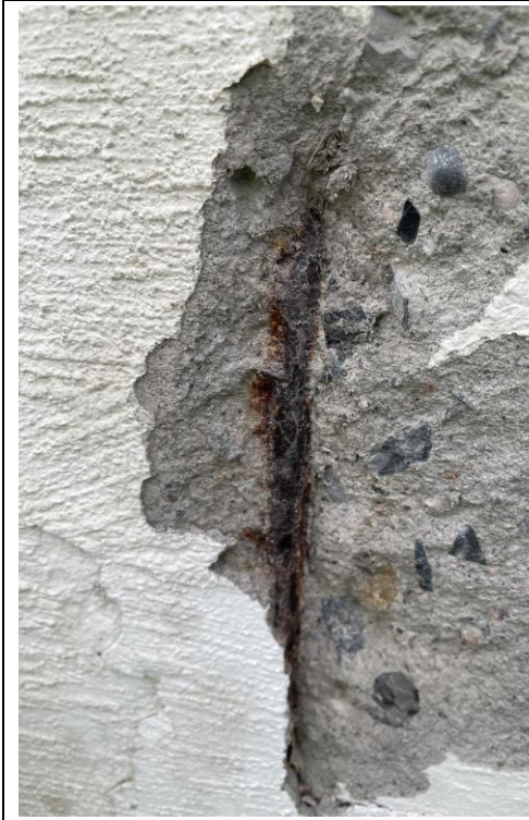
5: Synlig korrodert armering bak delaminering. Avskalling av betong etter lett hammerbanking.
