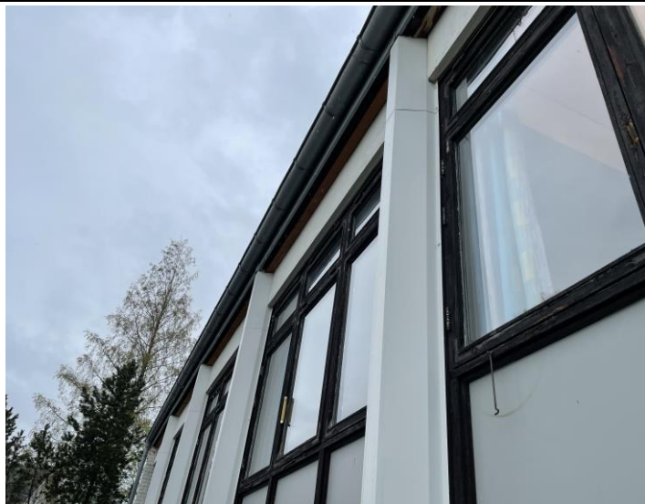
2: Det er etablert beslag på vertikale søyler.
