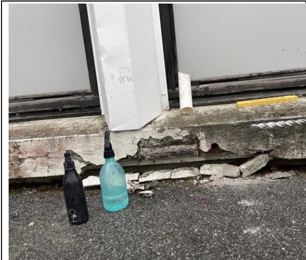
9: Bildet viser lokalitet L1, drager mot bakkenivå. Større avskallinger og synlig noe korrodert armering.
