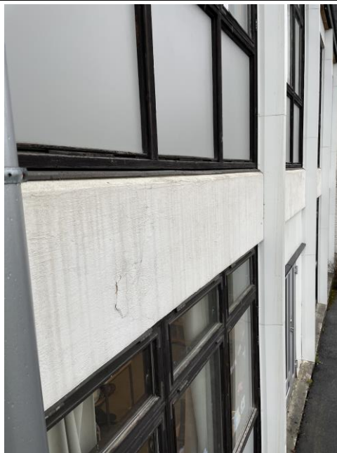
4: Delaminering av betong i etasjeskillere. Det ble observert mange delamineringer (løs betong i overflaten) av denne typen i etasjeskillere.
