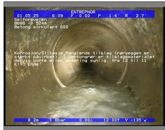
Foto: 5844_5244_8688_05022021_064021.JPG 8,2m, Korrosjon/Slitasje, Manglende tilslag (rørveggen er sterkt påvirket), I bertongrør er tilslagsmaterialet delvis borte eller armering synlig, fra 12 til 11 Kl., Ende
