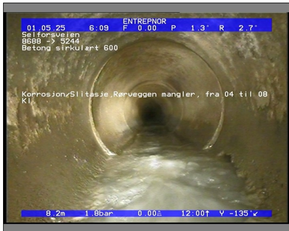
Foto: 5844_5244_8688_05022021_064008.JPG 8,2m, Korrosjon/Slitasje, Rørveggen mangler, fra 04 til 08 Kl.
