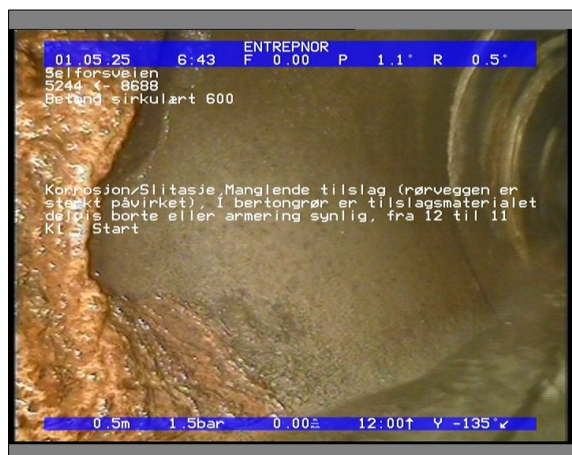
Foto: 5844_5244_8688_05022021_071410.JPG 51,3m, Korrosjon/Slitasje, Manglende tilslag (rørveggen er sterkt påvirket), I bertongrør er tilslagsmaterialet delvis borte eller armering synlig, fra 01 til 12 Kl., Start
