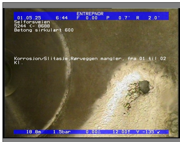
Foto: 5844_5244_8688_05022021_071545.JPG 32,97m, Korrosjon/Slitasje, Rørveggen mangler, fra 10 til 11 Kl.
