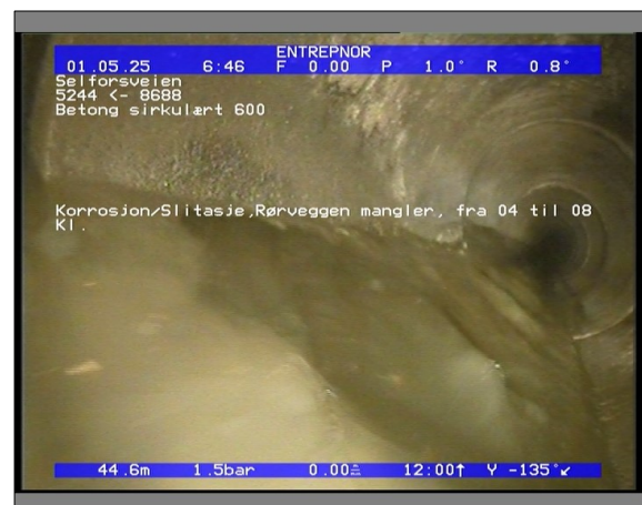
Foto: 5844_5244_8688_05022021_071747.JPG 7,2m, Korrosjon/Slitasje, Rørveggen mangler, fra 04 til 08 Kl.
