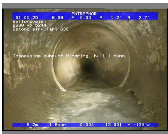
Foto: 5844_5244_8688_05022021_064046.JPG 8,2m, Inspeksjon avbrutt Hindring, hull i bunn
