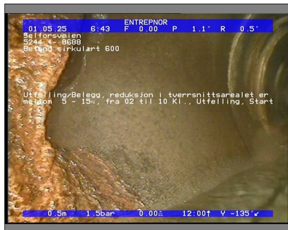
Foto: 5844_5244_8688_05022021_071424.JPG 51,3m, Utfelling/Belegg, reduksjon i tverrsnittsarealet er mellom 5 - 15%, fra 02 til 10 Kl., Utfelling, Start
