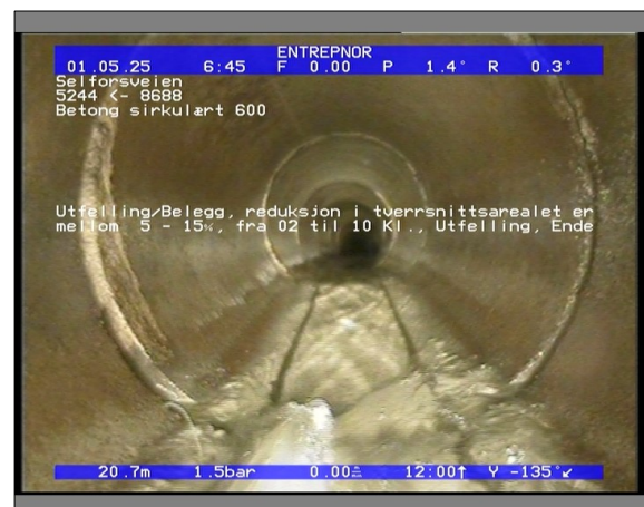
Foto: 5844_5244_8688_05022021_071604.JPG 31,01m, Utfelling/Belegg, reduksjon i tverrsnittsarealet er mellom 5 - 15%, fra 02 til 10 Kl., Utfelling, Ende
