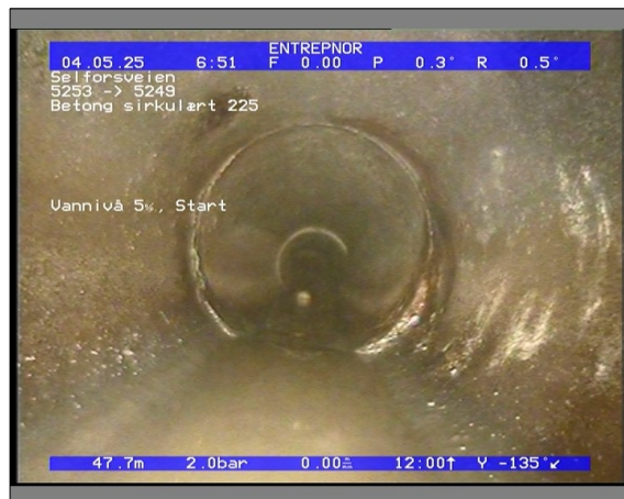
Foto: 5854_5249_5253_05022021_044527.JPG 47,74m, Vannivå 5%, Start
