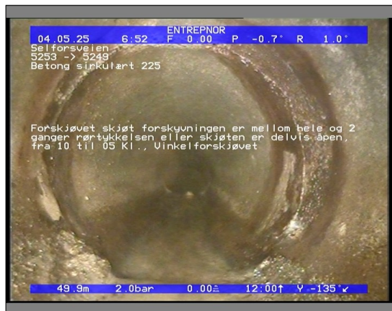
Foto: 5854_5249_5253_05022021_044632.JPG 49,92m, Forskjøvet skjøt forskyvningen er mellom hele og 2 ganger rørtykkelsen eller skjøten er delvis åpen, fra 10 til 05 Kl., Vinkelforskjøvet
