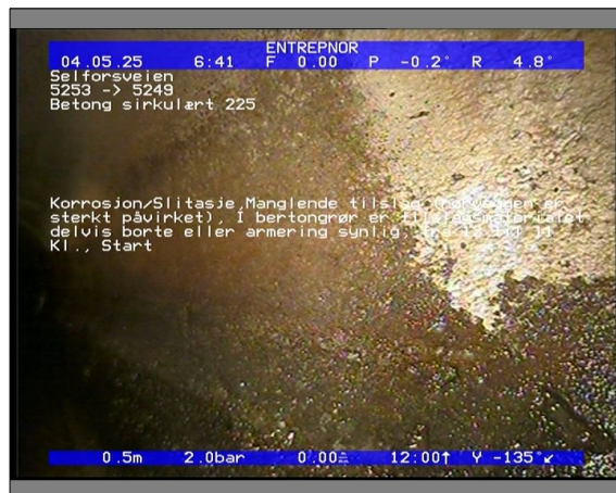
Foto: 5854_5249_5253_05022021_043530.JPG 0,5m, Korrosjon/Slitasje, Manglende tilslag (rørveggen er sterkt påvirket), I bertongrør er tilslagsmaterialet delvis borte eller armering synlig, fra 12 til 11 Kl., Start
