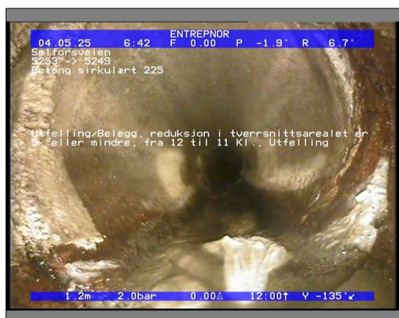
Foto: 5854_5249_5253_05022021_043625.JPG 1,25m, Utfelling/Belegg, reduksjon i tverrsnittsarealet er 5% eller mindre, fra 12 til 11 Kl., Utfelling
