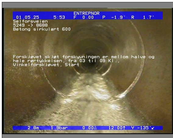
Foto: 5848_8688_5249_05022021_062400.JPG 2,84m, Forskjøvet skjøt forskyvningen er mellom halve og hele rørtykkelsen, fra 03 til 09 Kl., Vinkelforskjøvet, Start
