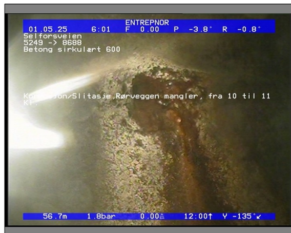
Foto: 5848_8688_5249_05022021_063243.JPG 56,79m, Korrosjon/Slitasje, Rørveggen mangler, fra 10 til 11 Kl.
