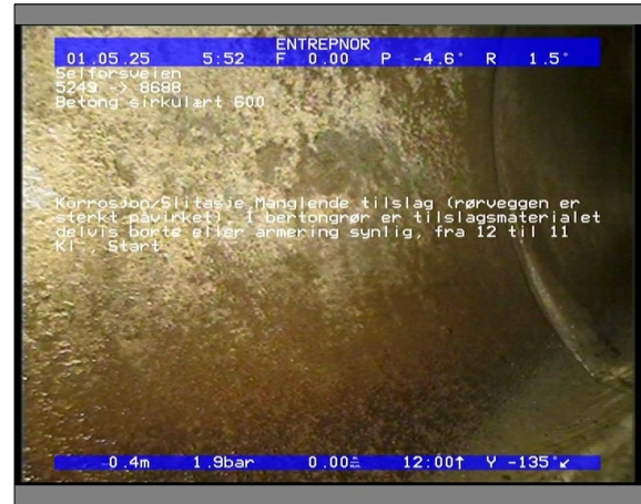
Foto: 5848_8688_5249_05022021_062331.JPG 0,49m, Korrosjon/Slitasje, Manglende tilslag (rørveggen er sterkt påvirket), I bertongrør er tilslagsmaterialet delvis borte eller armering synlig, fra 12 til 11 Kl., Start
