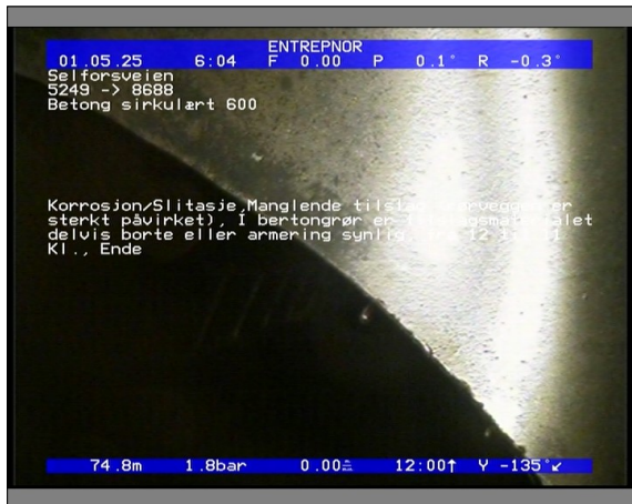
Foto: 5848_8688_5249_05022021_063515.JPG 74,83m, Korrosjon/Slitasje, Manglende tilslag (rørveggen er sterkt påvirket), I bertongrør er tilslagsmaterialet delvis borte eller armering synlig, fra 12 til 11 Kl., Ende
