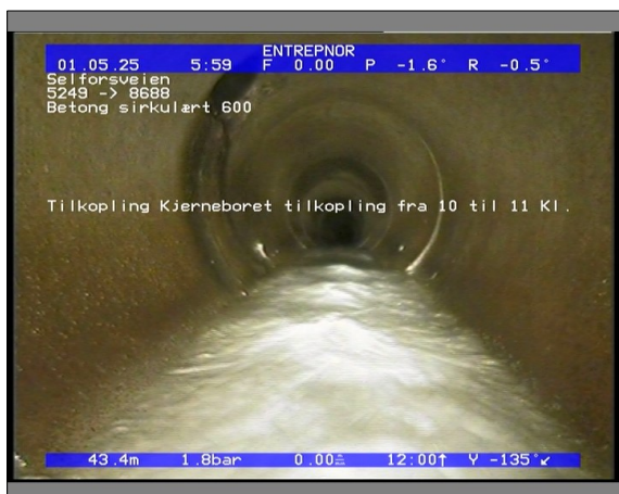
Foto: 5848_8688_5249_05022021_063041.JPG 43,41m, Tilkopling Sadelgren med innhugget hull fra 10 til 11 Kl.
