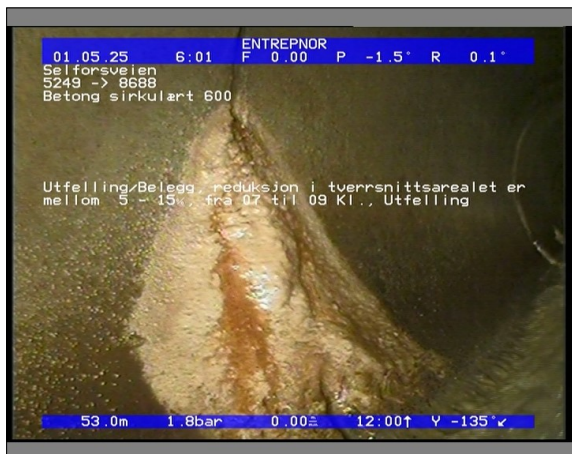
Foto: 5848_8688_5249_05022021_063201.JPG 53,07m, Utfelling/Belegg, reduksjon i tverrsnittsarealet er mellom 5 - 15%, fra 07 til 09 Kl., Utfelling
