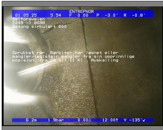
Foto: 5848_8688_5249_05022021_062509.JPG 6,24m, Sprukket rør, Rørbiter har løsnet eller mangler/teglstein mangler fra sin opprinnlige posisjon, fra 08 til 11 Kl., Avskalling
