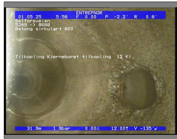
Foto: 5848_8688_5249_05022021_062935.JPG 31,92m, Tilkopling Kjerneboret tilkopling 12 Kl.
