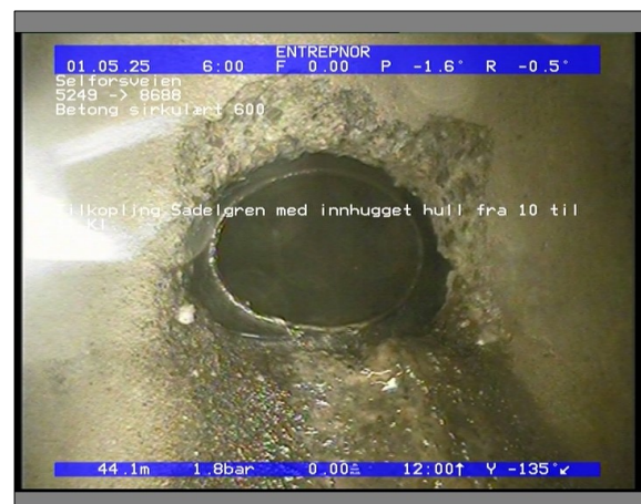
Foto: 5848_8688_5249_05022021_063104.JPG 43,41m, Tilkopling Sadelgren med innhugget hull fra 10 til 11 Kl.
