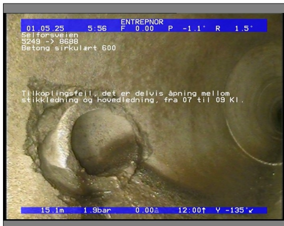
Foto: 5848_8688_5249_05022021_062706.JPG 15,17m, Tilkoplingsfeil, det er delvis åpning mellom stikkledning og hovedledning, fra 07 til 09 Kl.
