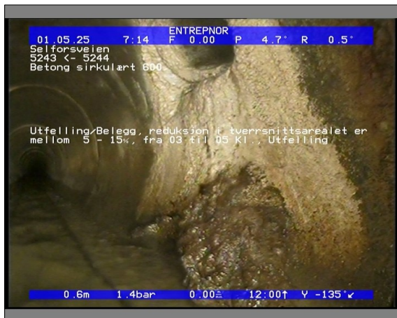
Foto: 5842_5243_5244_05022021_074541.JPG 0,65m, Utfelling/Belegg, reduksjon i tverrsnittsarealet er mellom 5 - 15%, fra 03 til 05 Kl., Utfelling
