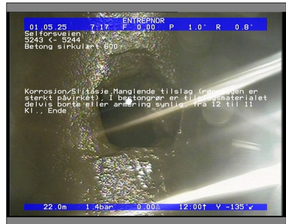
Foto: 5842_5243_5244_05022021_074815.JPG 22,02m, Korrosjon/Slitasje, Manglende tilslag (rørveggen er sterkt påvirket), I betongrør er tilslagsmaterialet delvis borte eller armering synlig, fra 12 til 11 KI., Ende
