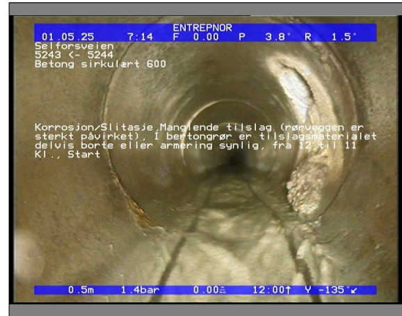
Foto: 5842_5243_5244_05022021_074524.JPG 0,5m, Korrosjon/Slitasje, Manglende tilslag (rørveggen er sterkt påvirket), I bertongrør er tilslagsmaterialet delvis borte eller armering synlig, fra 12 til 11 Kl., Start
